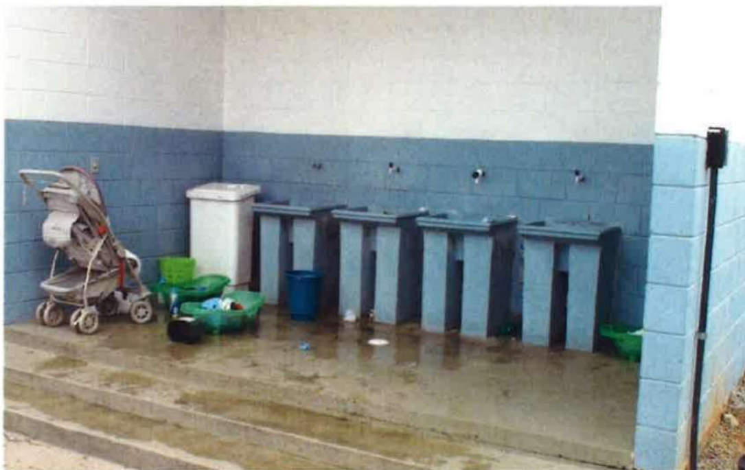
Tanques instalados na parte externa da ala materno-infantil
