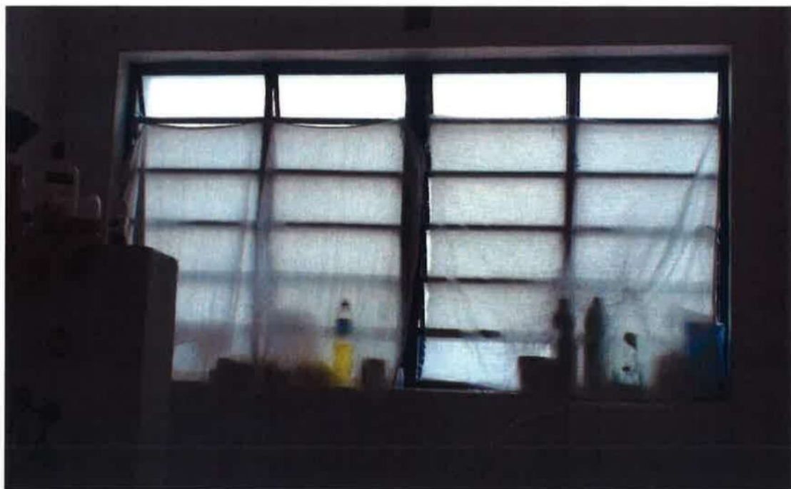
Outra vidraça de cela infantil precariamente vedada
