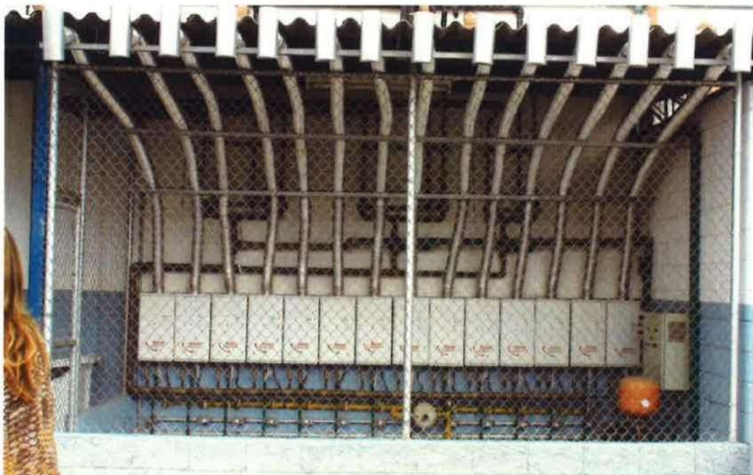
Sistema de aquecimento de água. Há banho quente em todos os raios
