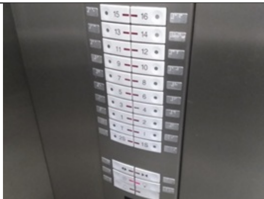
Foto 7 – Painel do elevador com sinalização em braile dos andares;
