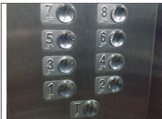
Foto 5 – Painel do elevador com sinalização em braile dos andares;
