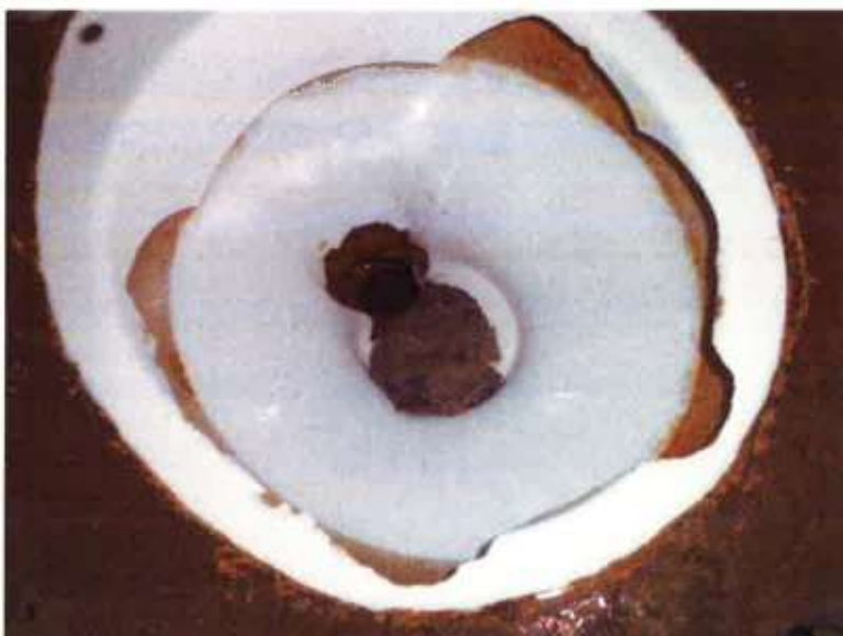
Cela do Seguro 10. Vaso Sanitário Quebrado. O Chuveiro se localiza logo acima, o que faz com que muitos presos se cortem ao tomarem banho.
