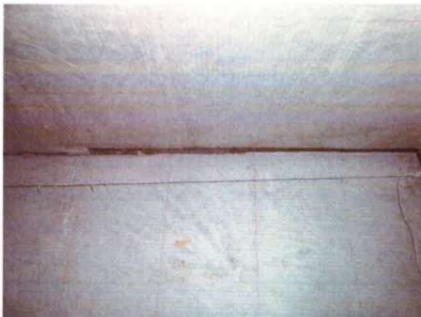
Cela do Seguro 11. Buraco de insetos, ratos e infiltração
