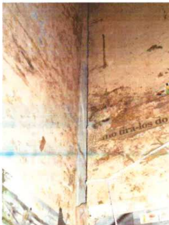
Cela do Seguro 11. Buraco na Parede, infiltração e goteira.
