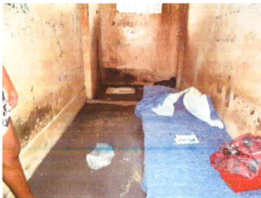
Cela do setor disciplinar. Não há vaso sanitário, apenas um buraco no chão. Mofo e sujeira.
