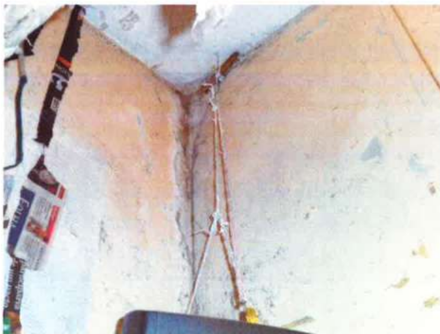
Cela do Seguro 11. Fios desencapados e infiltração muito próximas uma da outra. O risco de ocorrer um acidente é grande, visto que há 17 pessoas em um espaço para 03.
