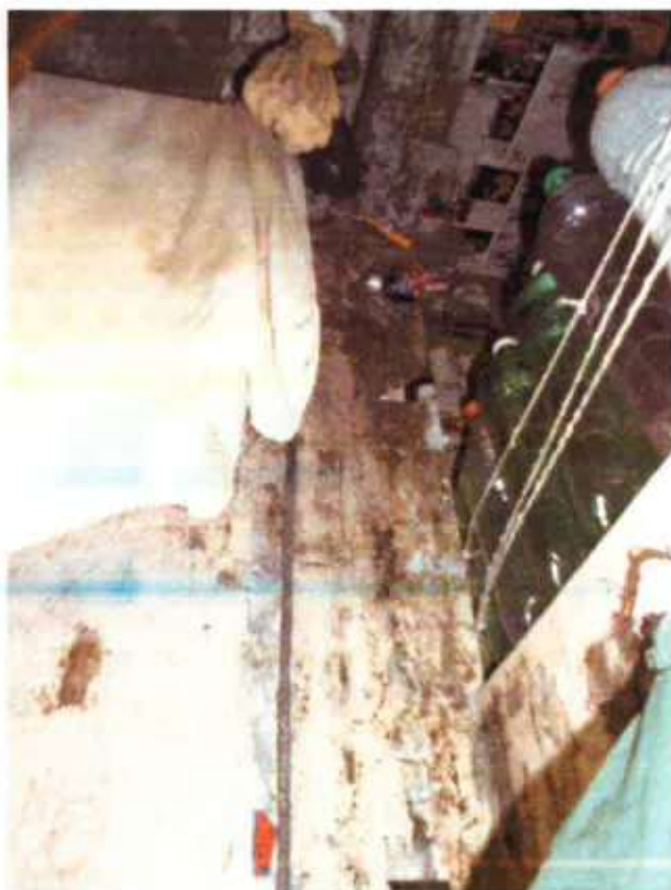
Cela do Seguro 11. Infiltração e Goteira.
