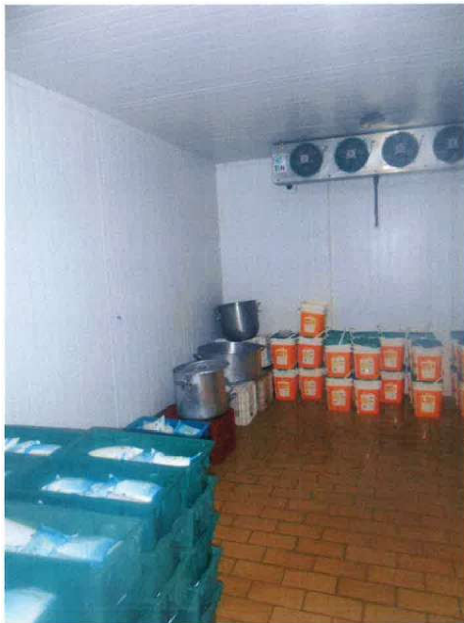
Foto 24 – Câmara de refrigeração
