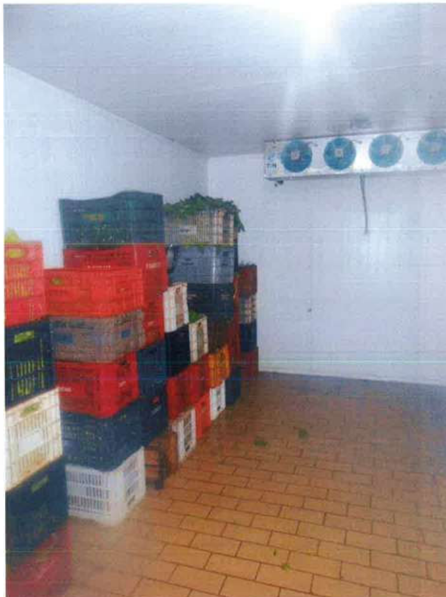
Foto 25 - Câmara de refrigeração [2]
