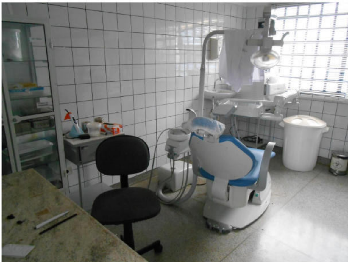
Figura 11. Gabinete odontológico instalado na unidade.
