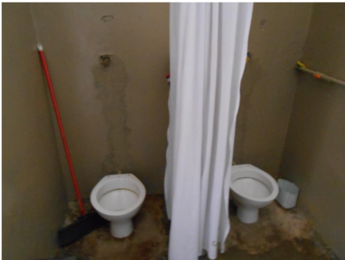
Figura 12. Sanitários de cela no Raio 01.
