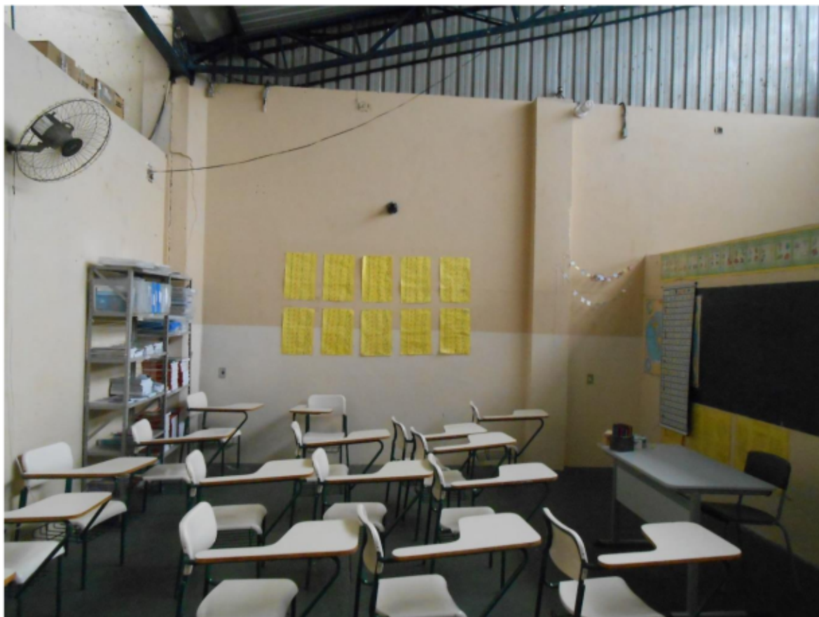
Figura 42. Sala de aulas instalada na unidade.
