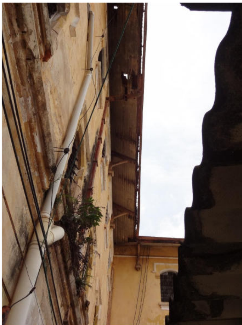
Encanamento e fiações improvisadas na parte externa do prédio
