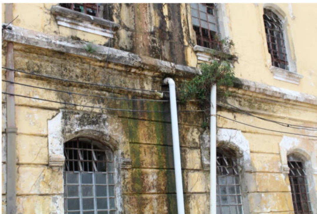
Encanamentos improvisados e infiltrações na parte externa do prédio
