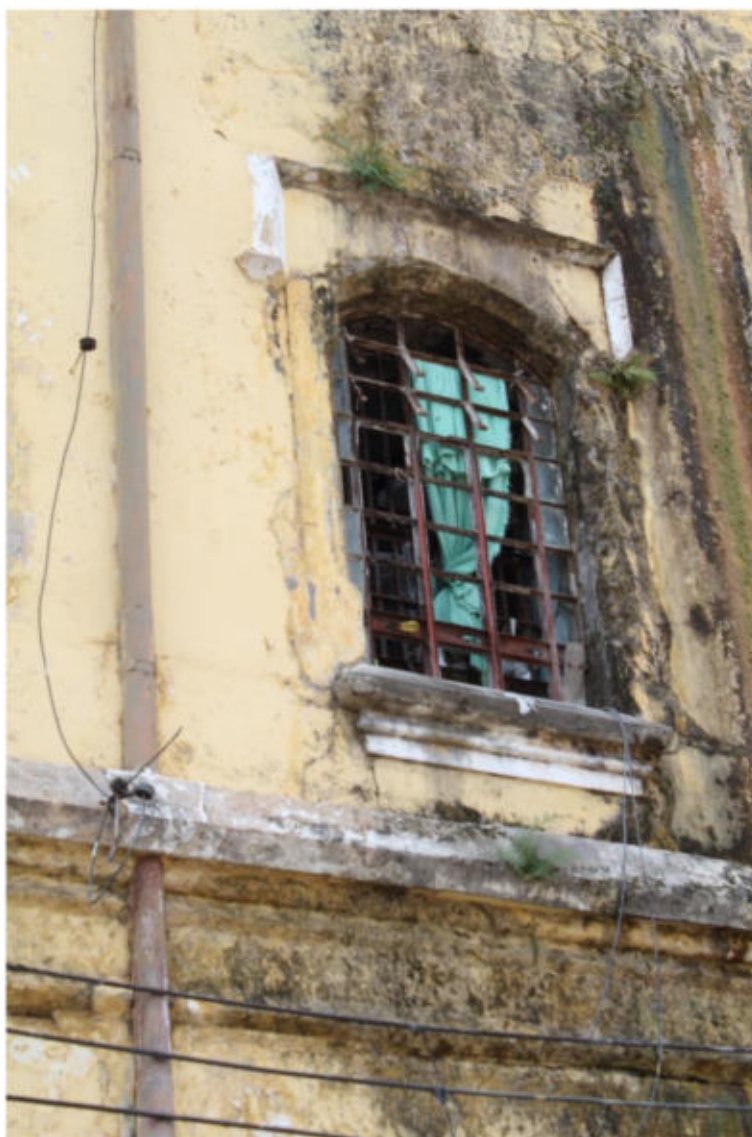
Infiltrações na parte externa do prédio
