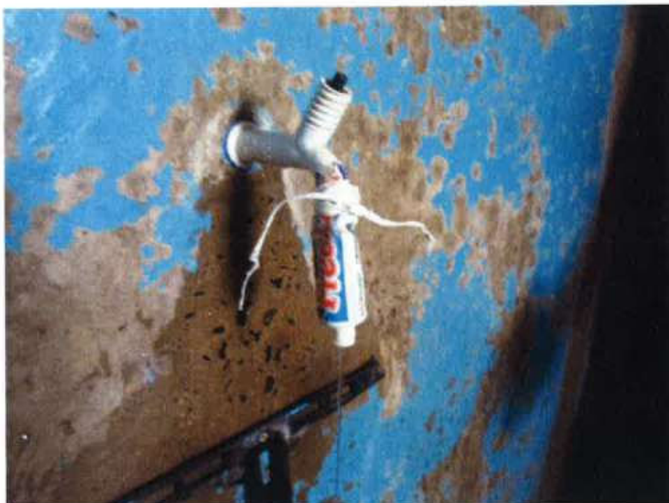
Adaptação no banheiro precário do raio
