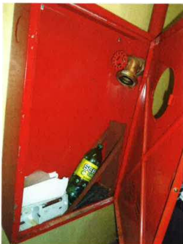
Local em que deveria haver mangueira contra incêndio é utilizado para depósito de lixo
