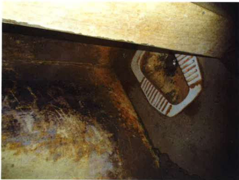
Banheiro de cela do setor disciplinar extremamente precário
