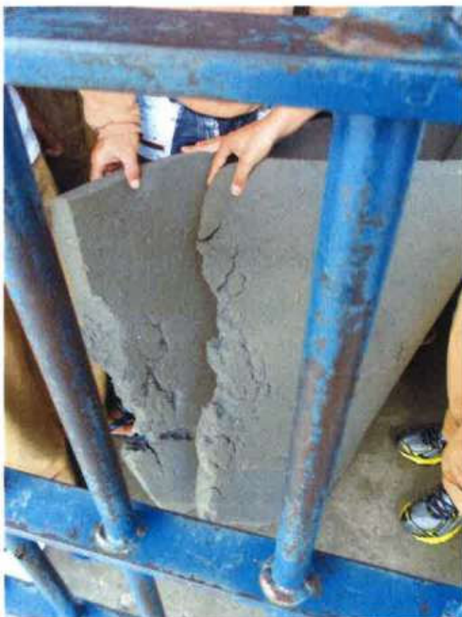
Estado precário dos colchões
