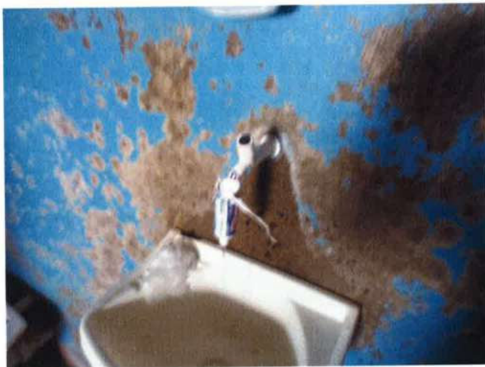
Adaptação no precário banheiro da cela do raio
