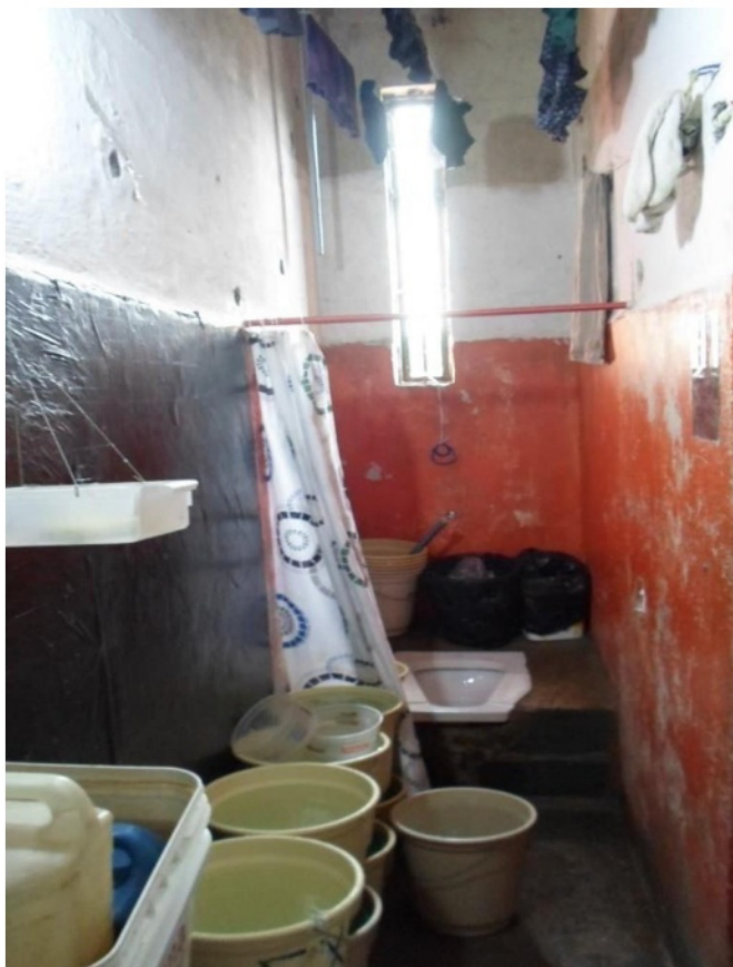
Condições inadequadas do banheiro das celas e baldes para armazenamento de água.
