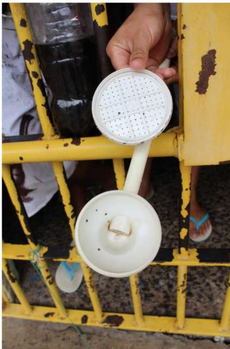
(Chuveiro da cela com impurezas em razão da má qualidade da água e falta de manutenção)
