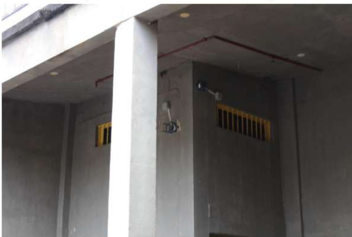
(Câmeras instaladas no interior do Pavilhão 7)
