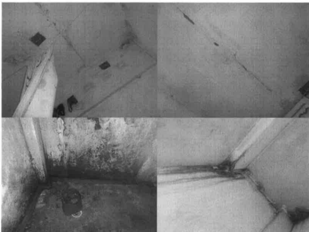
Infiltrações no interior da cela
