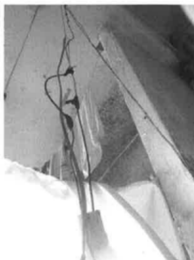
Instalação elétrica precária (em ambiente com infiltrações)
