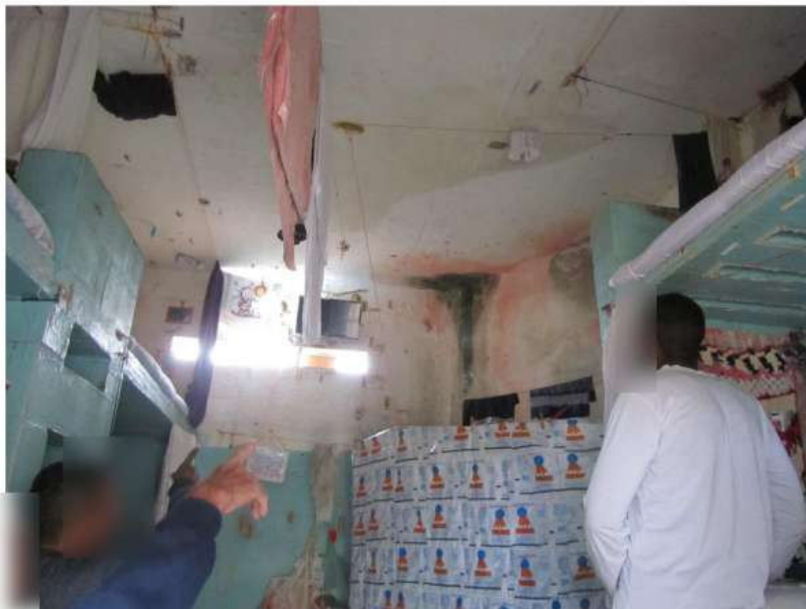
(celas deterioradas – infiltração)
