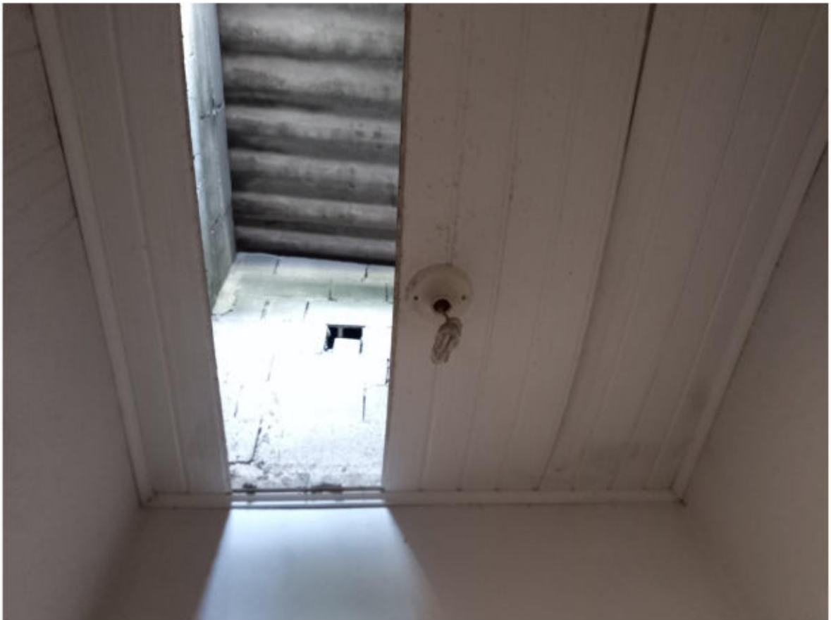
Buraco no forro do teto de um dos banheiros para uso das visitantes
