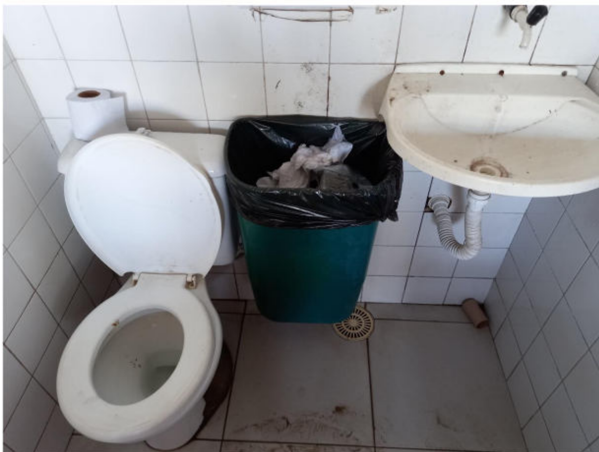
Banheiro para uso das visitantes, em más condições de higiene
