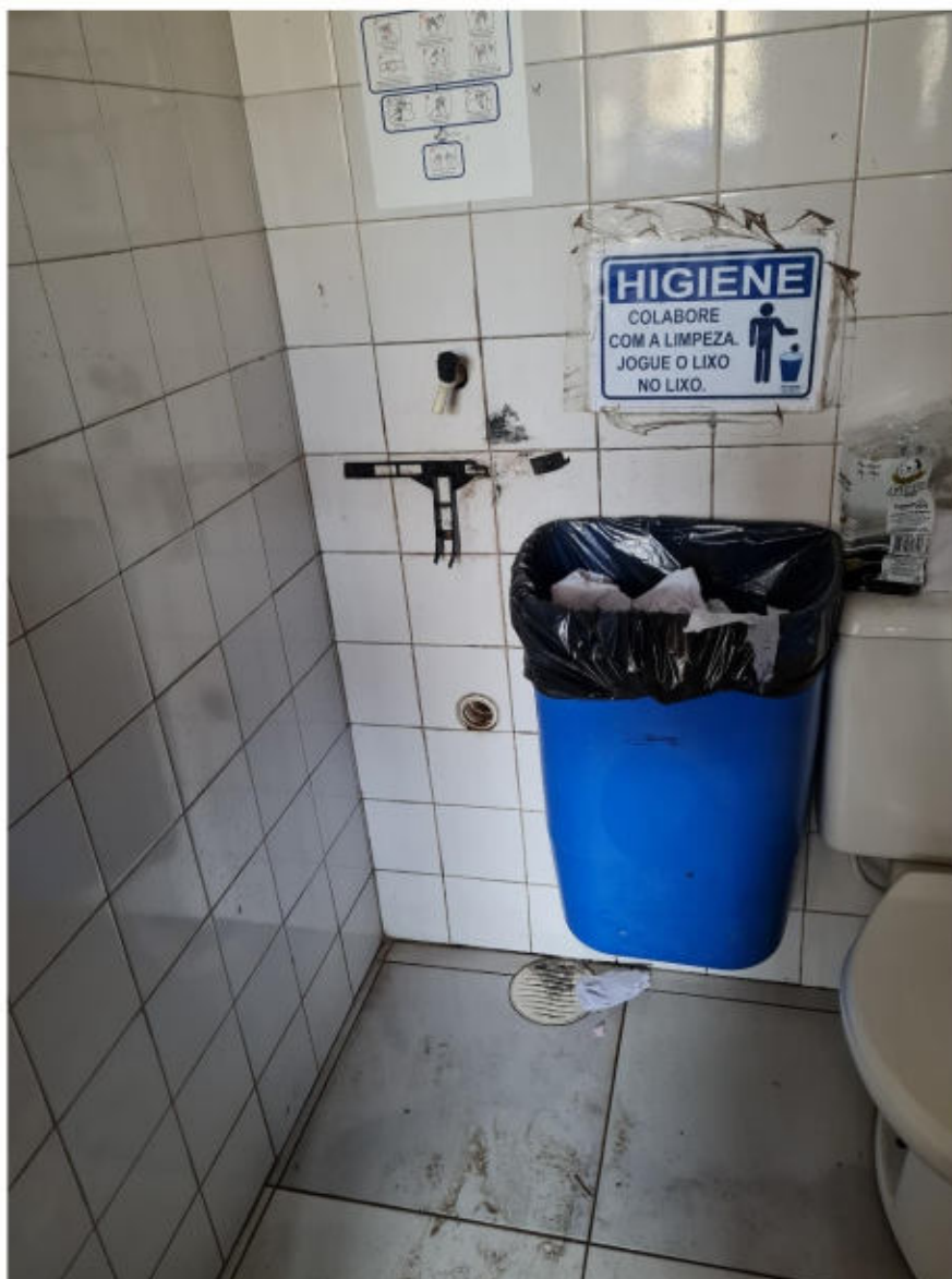
Banheiro sem pia
