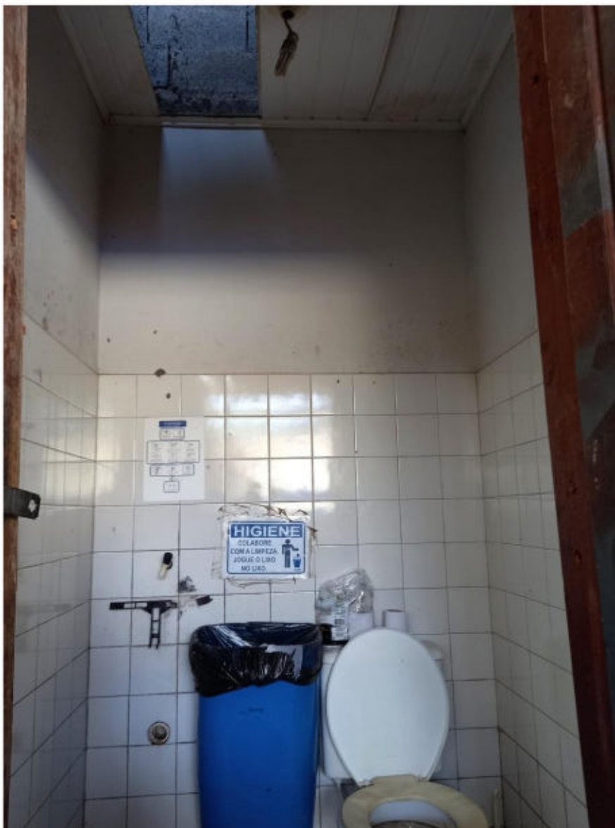
Buraco no forro do teto de um dos banheiros para uso das visitantes
