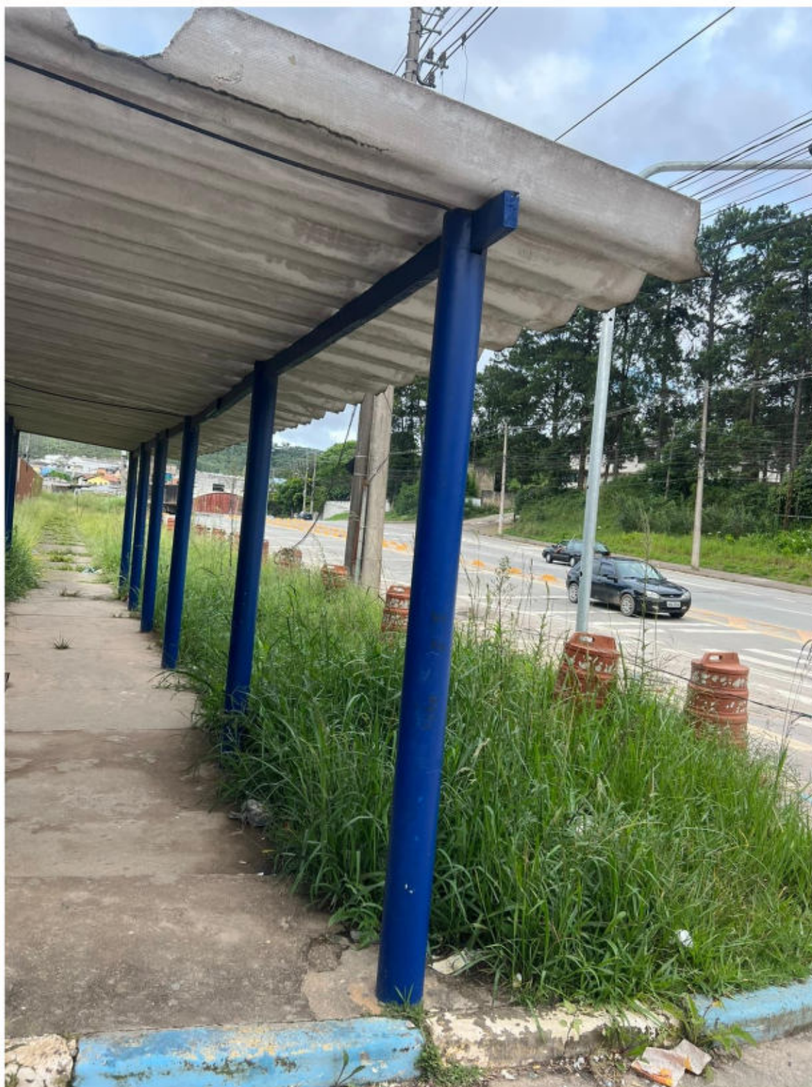
Local de formação da primeira fila de espera com cobertura insuficiente
