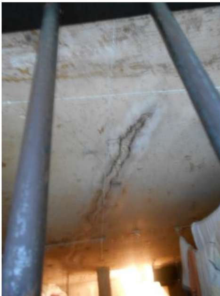
Infiltrações e fiação aparente
