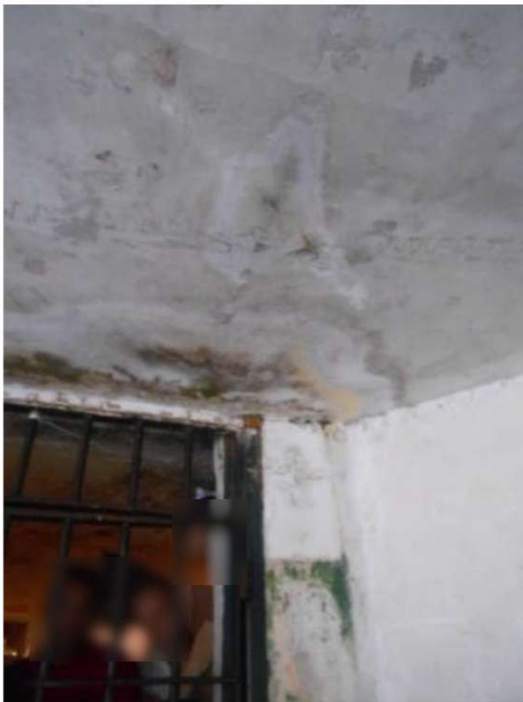
Péssimo estado de conservação – infiltrações
