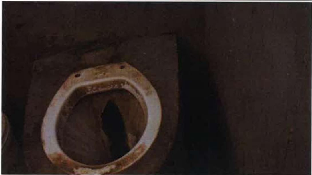
Cela da inclusão (privada quebrada)
