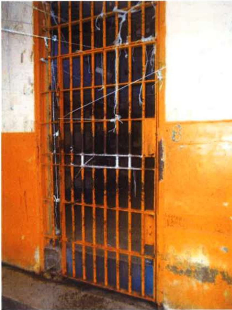
Cela 8 do raio 5 (inutilizada no dia da inspeção)
