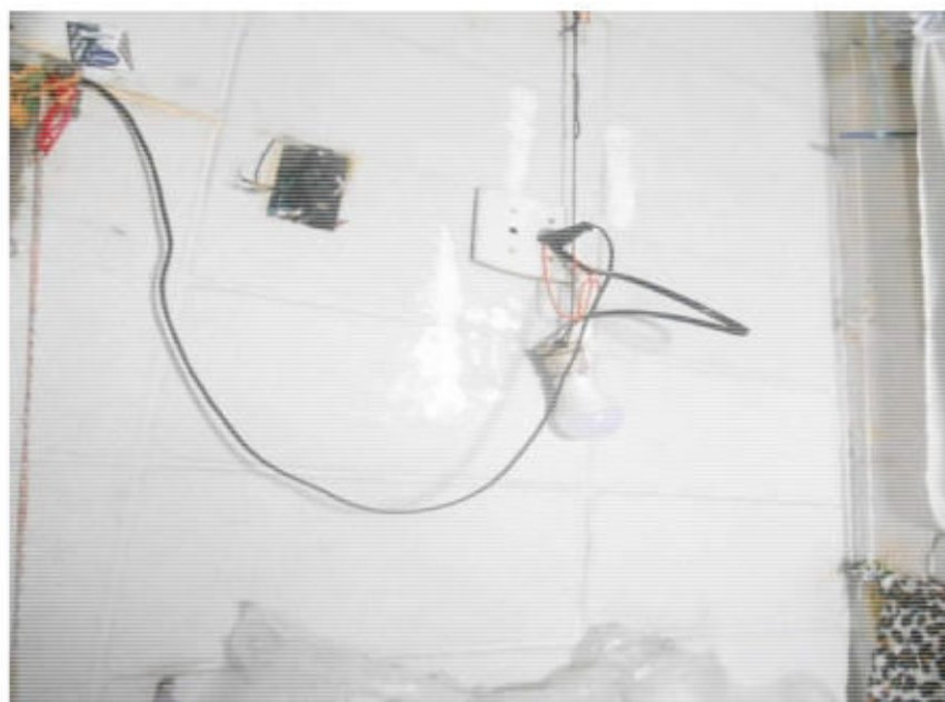
(Fiação exposta na cela)
