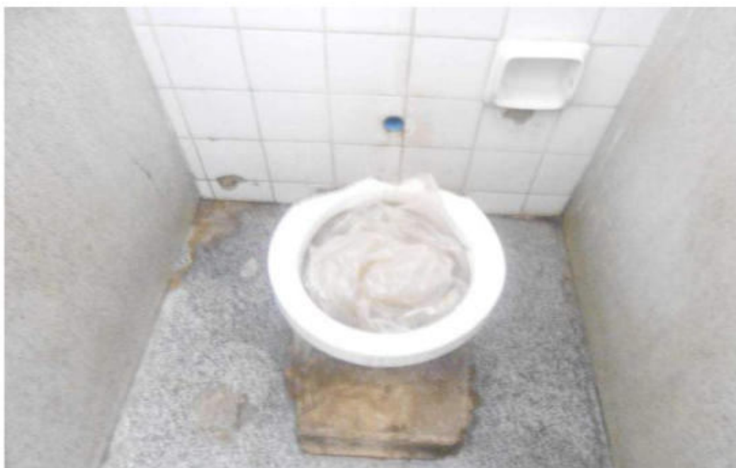
(Vaso sanitário quebrado e inutilizado)
