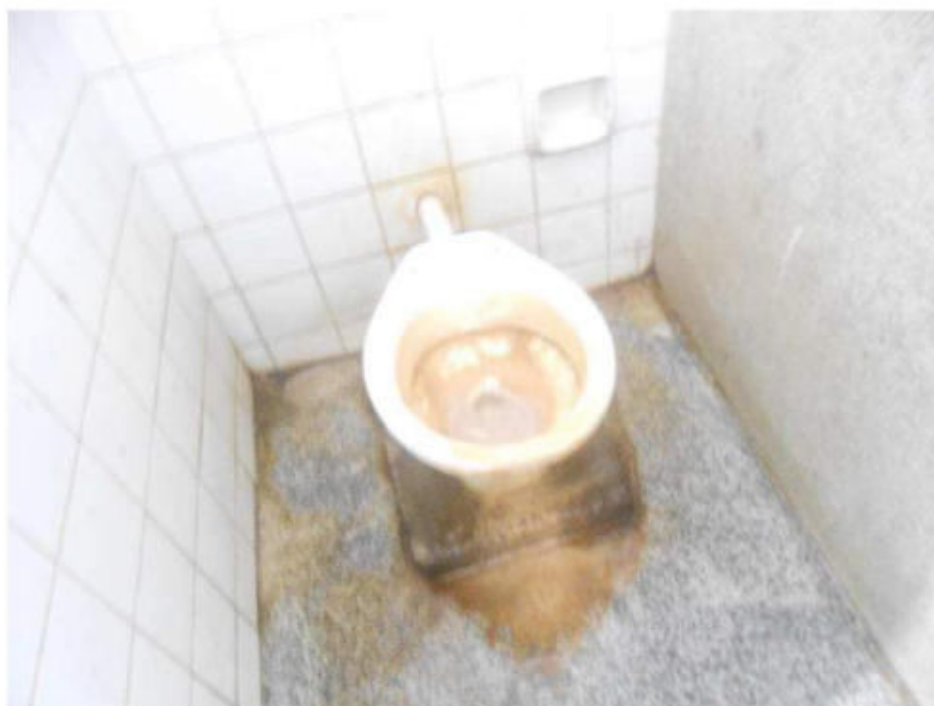
(Condições precárias do vaso sanitário)
