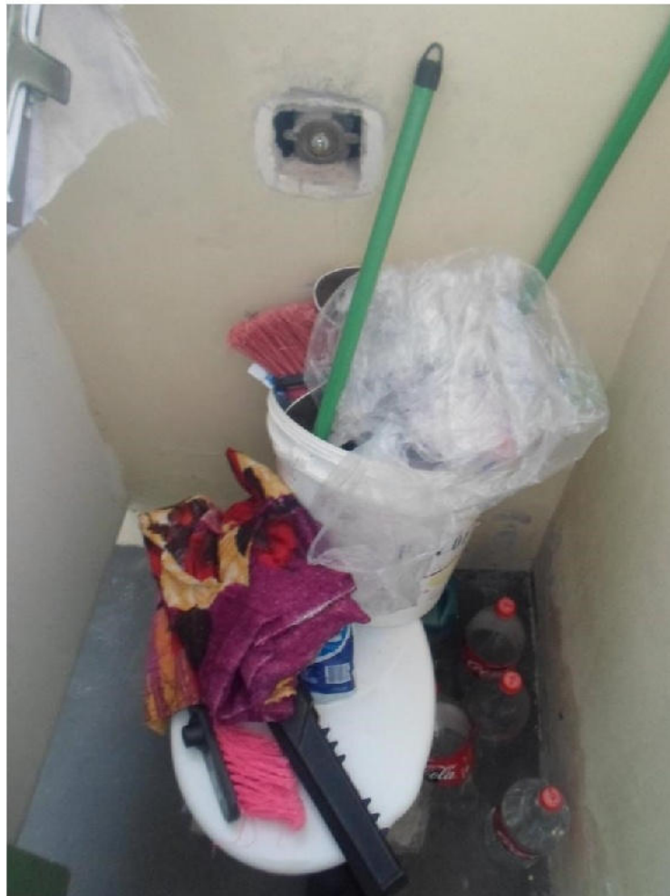
(Foto 07: sanitário quebrado – utilizado como “armário”)
