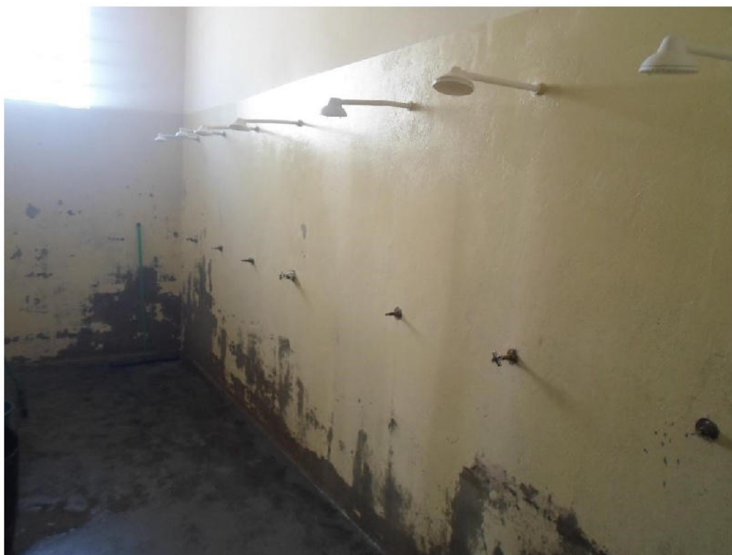
(Foto 10: Duchas na ala de progressão – não há água quente)
