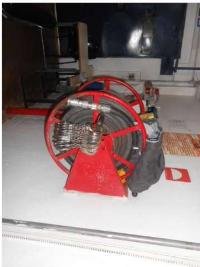
Mangueira contra incêndio
