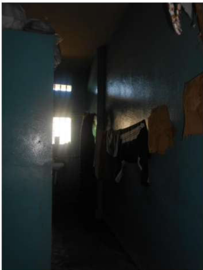
Cela sem a devida iluminação e ventilação no setor de seguro
