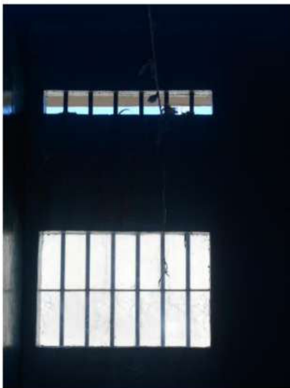
Cela do setor disciplinar (castigo) com vedação na parte inferior, que impede a devida circulação de ar
