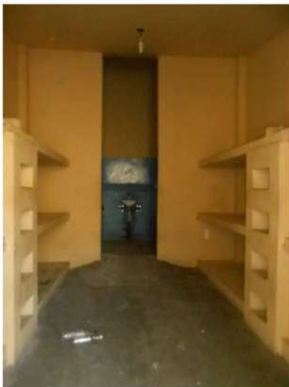
Cela de raio recém reformado- iluminação inadequada da estrutura
