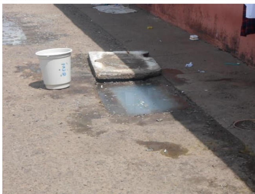
(fotos n. 28 e 29 – Esgoto entupido)
