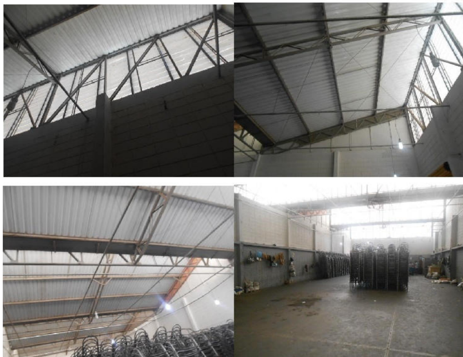
(fotos n. 31, 32, 33 e 34 – Galpões de trabalho sem ventilação adequada)
