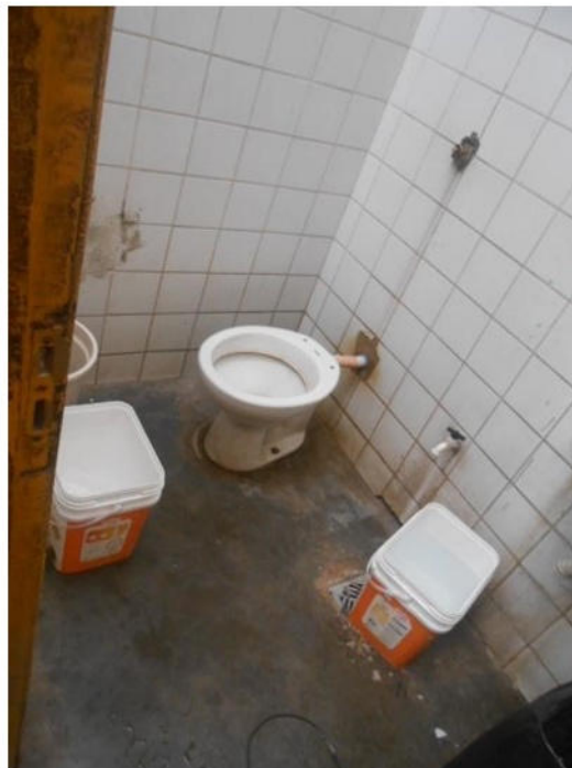
(foto n. 30 – Único banheiro em um dos setores de trabalho)
