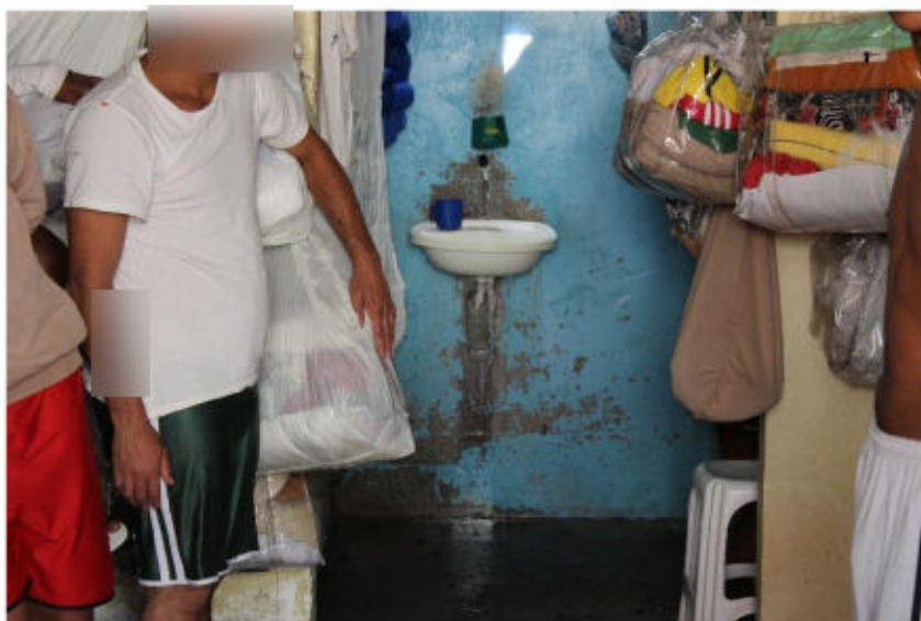
Cela com vazamento na pia e sem tubulação adequada
