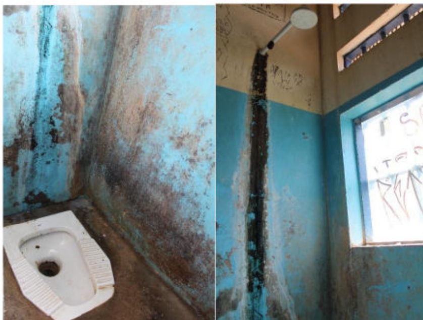
Chuveiro instalado imediatamente acima do vaso sanitário
