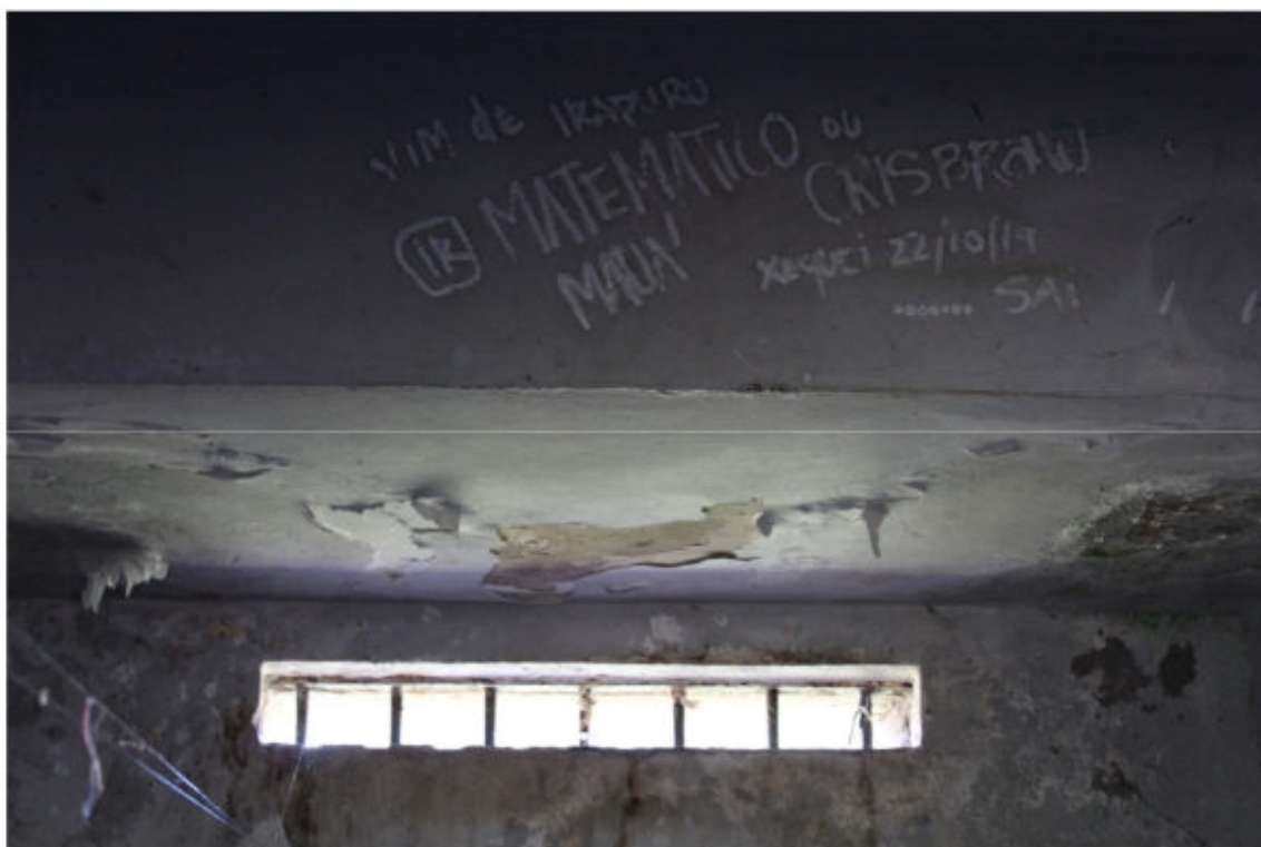
(estado de deterioração de celas em funcionamento)
