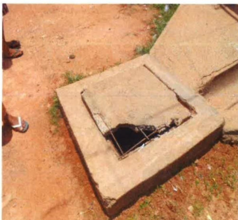
Foto 28 – Estrutura quebrada na unidade. Exterior do alojamento
