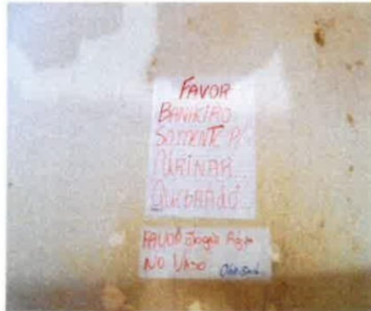
Foto 13 - Aviso sobre ausência de descarga no banheiro
