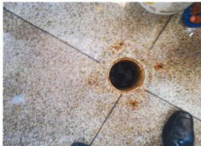
Foto 14 - Ralo aberto no banheiro
