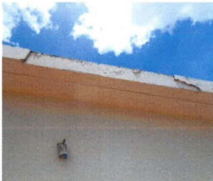
Foto 24 – Parte da estrutura do prédio dos alojamentos que cedeu recentemente
