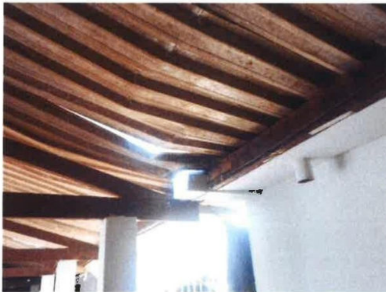
Foto 29 - Parte do teto cedido na única área de abrigo para chuva no pátio dos alojamentos
