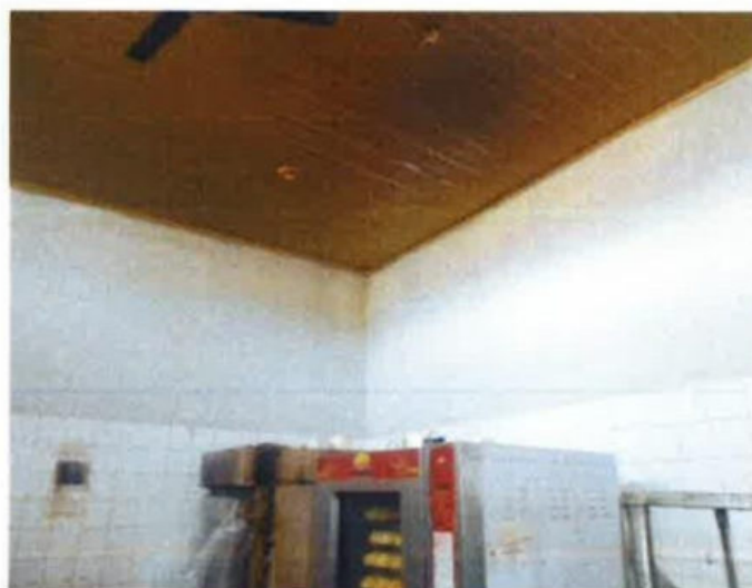
Foto 70 – Teto danificado devido ao calor do forno na padaria da unidade
