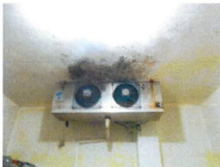
Foto 72 - Teto danificado devido ao calor no interior da unidade
