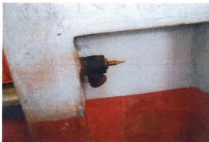
Foto 30 - Ausência de mangueira no hidrante
