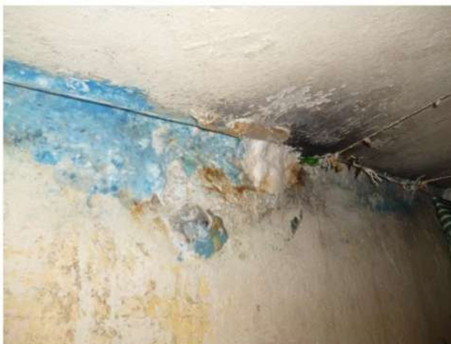
Celas com muita infiltração.
