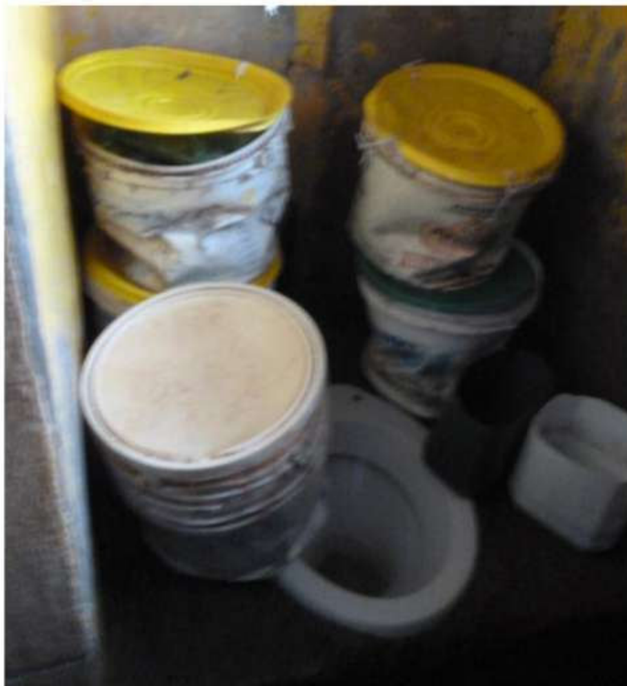
Vaso sanitário do setor de seguro.
