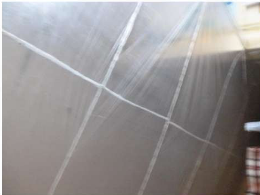
Detalhe da cobertura improvisada.
