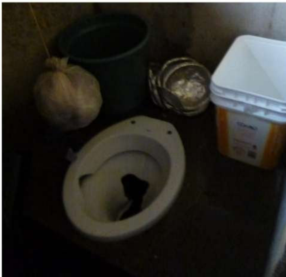
Vaso sanitário de outra cela, quebrado.
