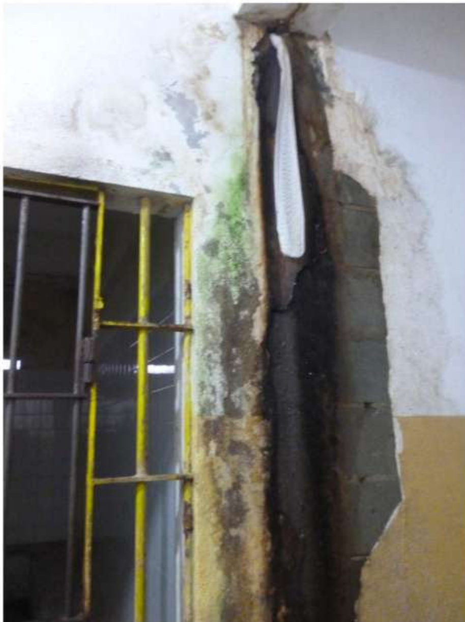
Mais um vazamento no setor da enfermaria.
