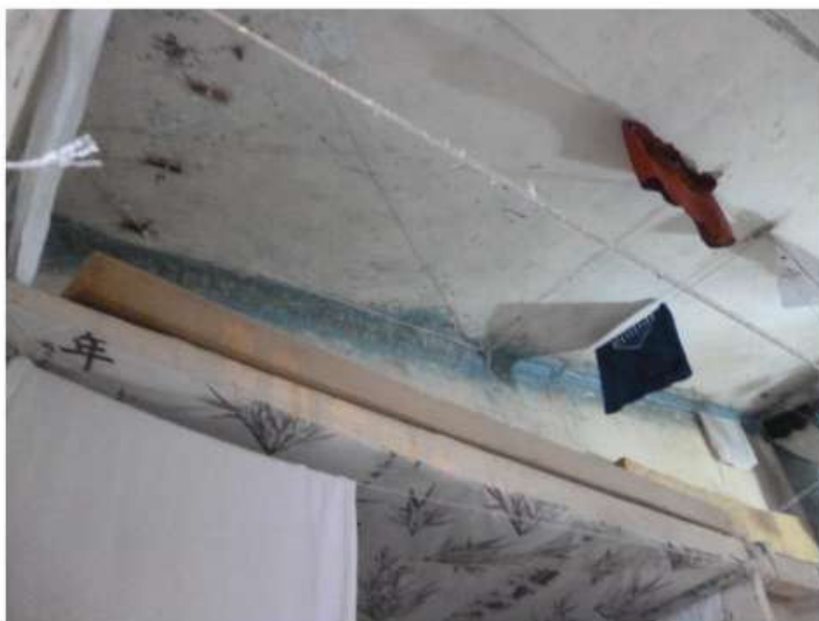
Sabão passado nas quinas das paredes, como forma de minimizar os efeitos dos vazamentos.
