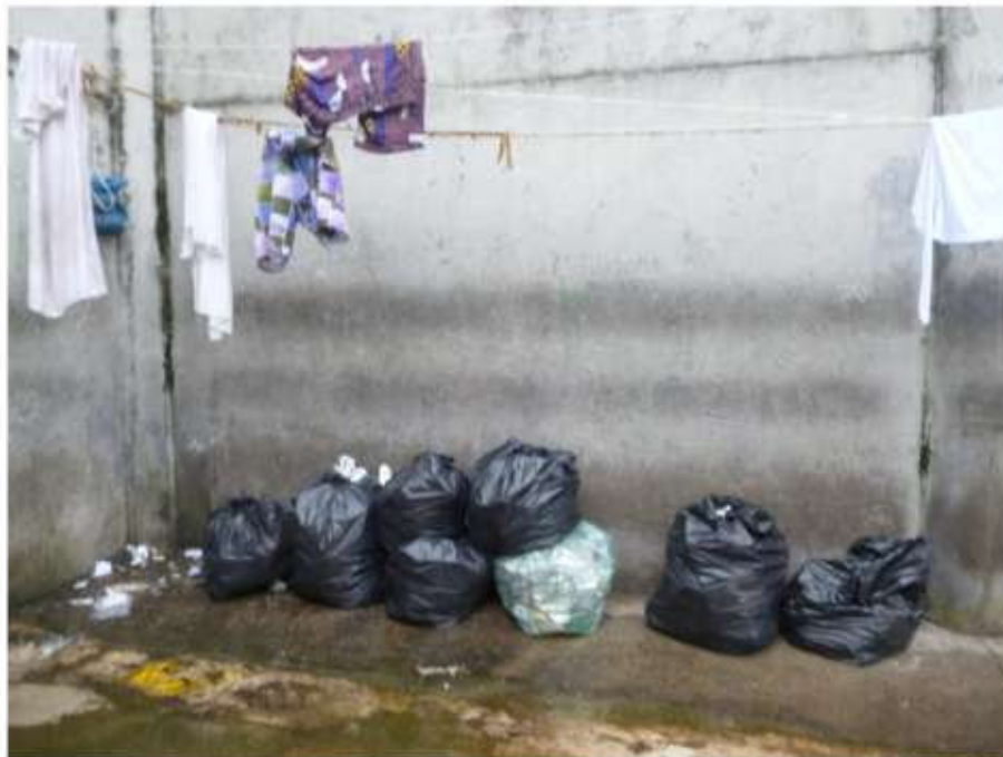
Sacos de lixo mantidos no pátio do raio, que só seriam recolhidos no dia seguinte. Mais vazamentos, também.
