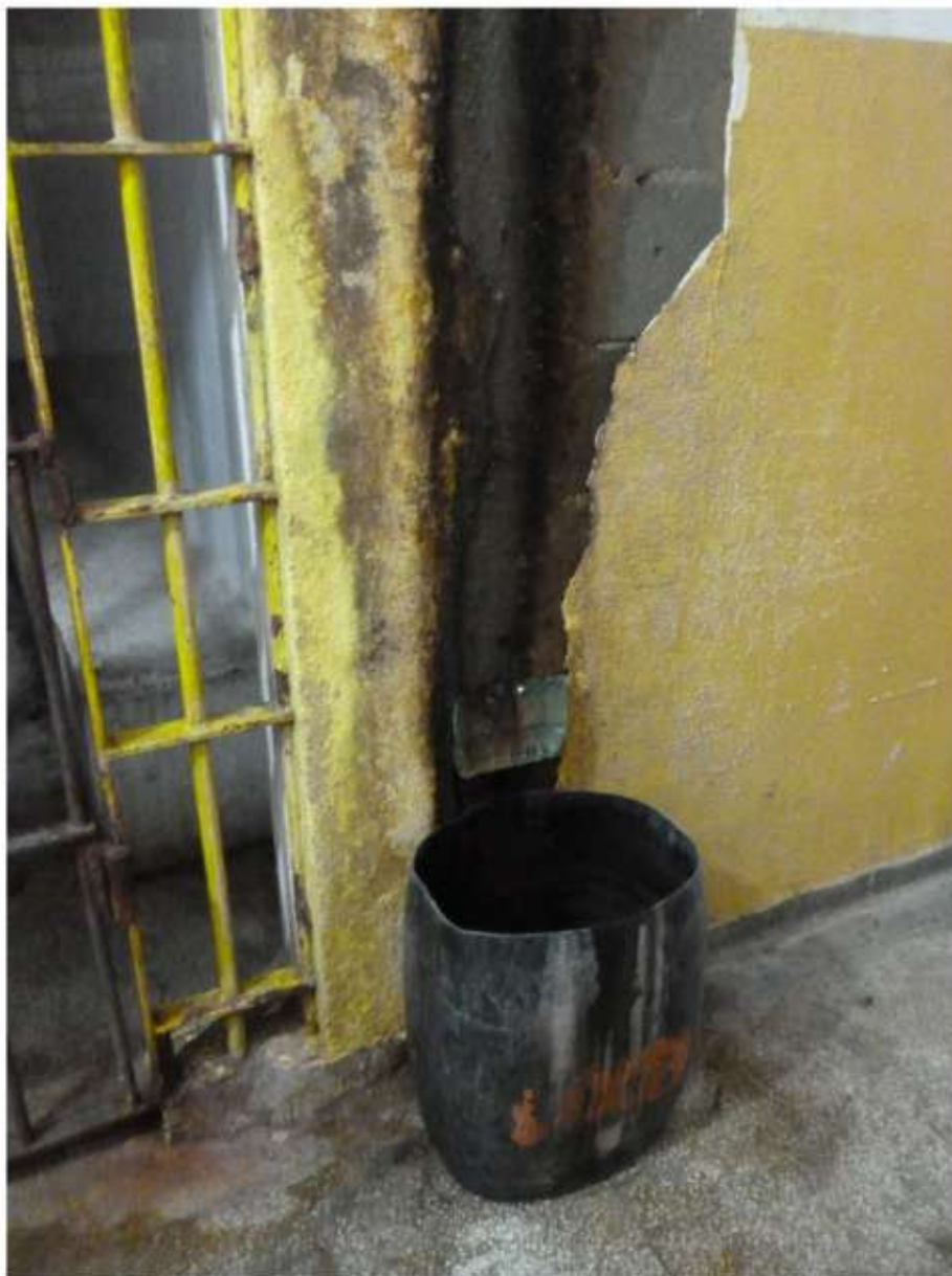
Outra foto do vazamento.
