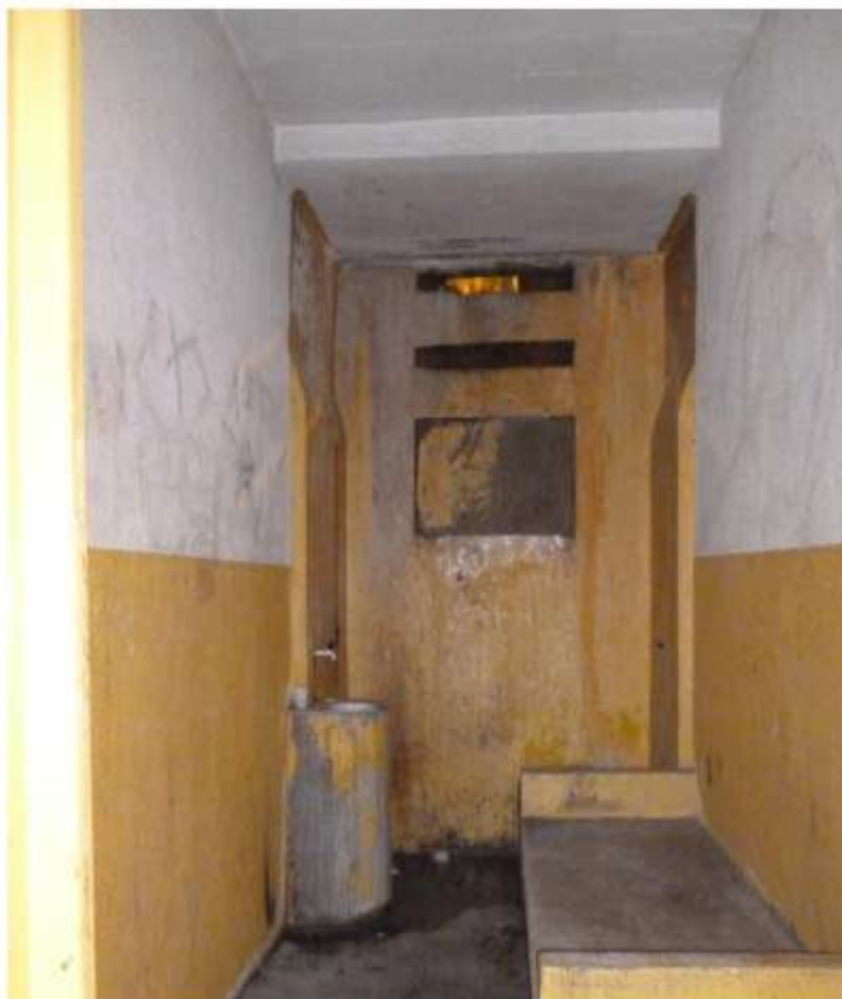
Outra cela da enfermaria cheia de infiltrações, que estava vazia no momento da visita.
