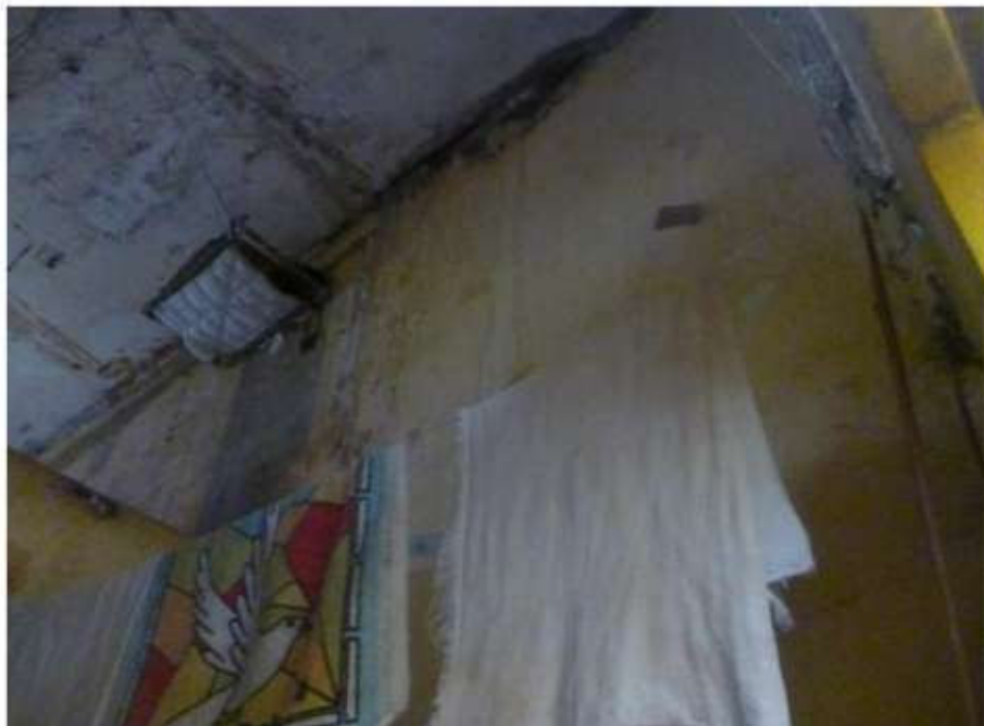
Detalhe das infiltrações em uma das celas do seguro.
