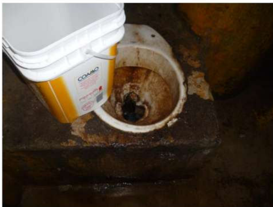
Sanitário quebrado em uma das celas do setor de inclusão.
