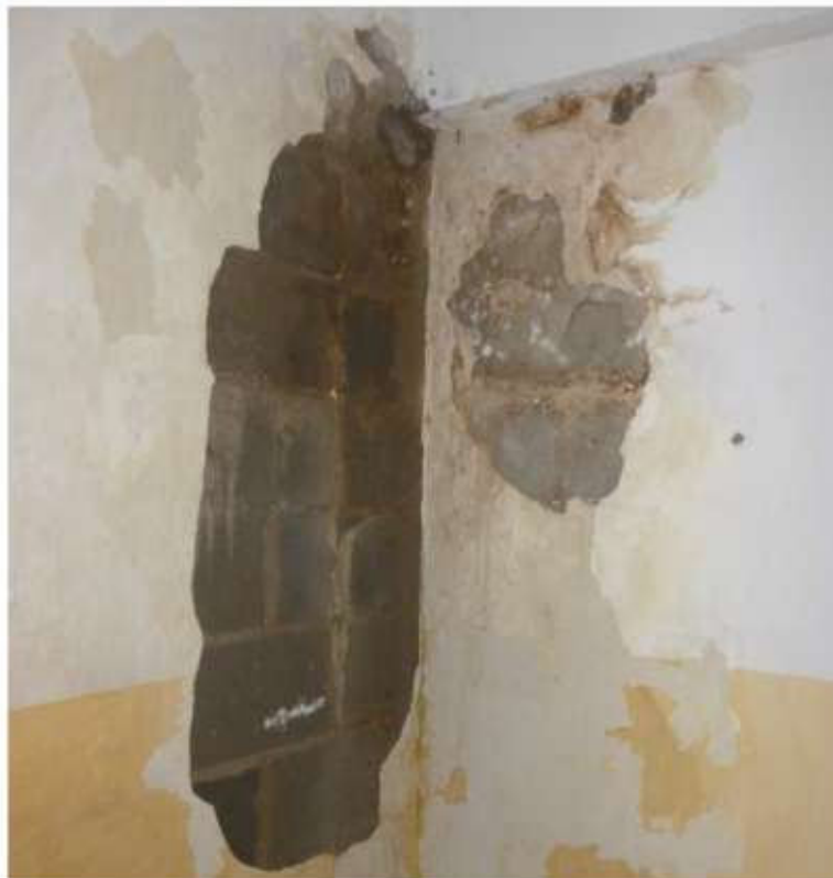
Parede da enfermaria com infiltrações.
