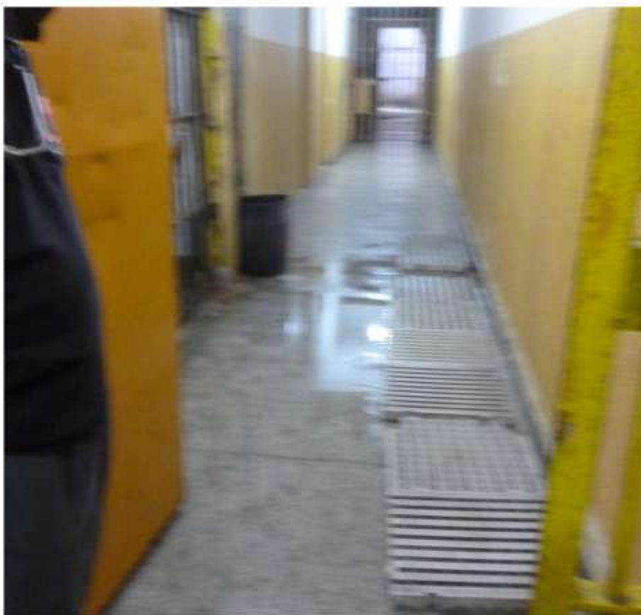
Corredor que dá acesso à ala da enfermaria, com o chão alagado em razão dos inúmeros vazamentos.
