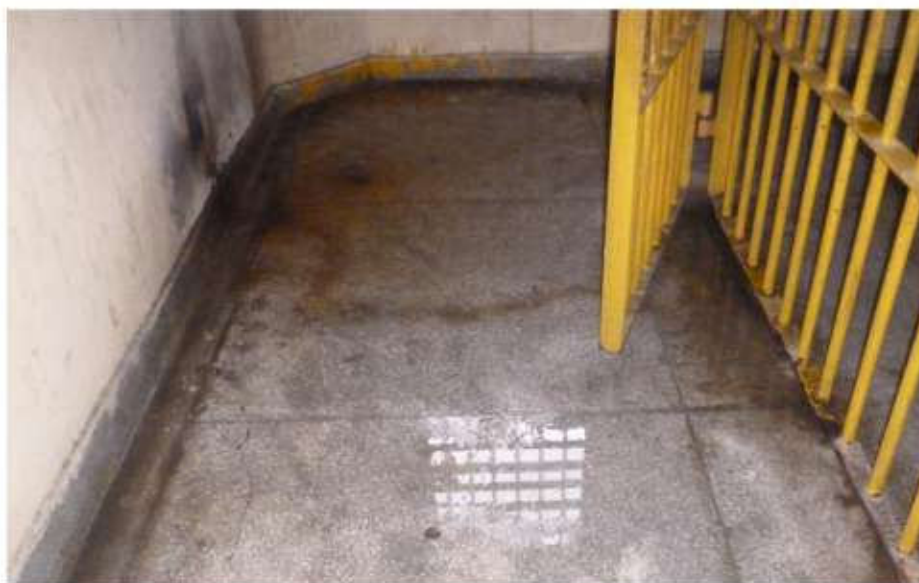
Mais um local alagado na unidade prisional.
