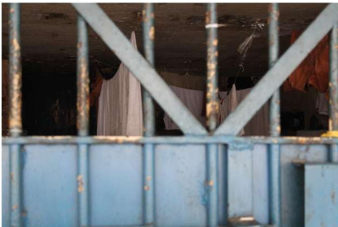
Péssimo estado das celas, com infiltrações por todo o teto
