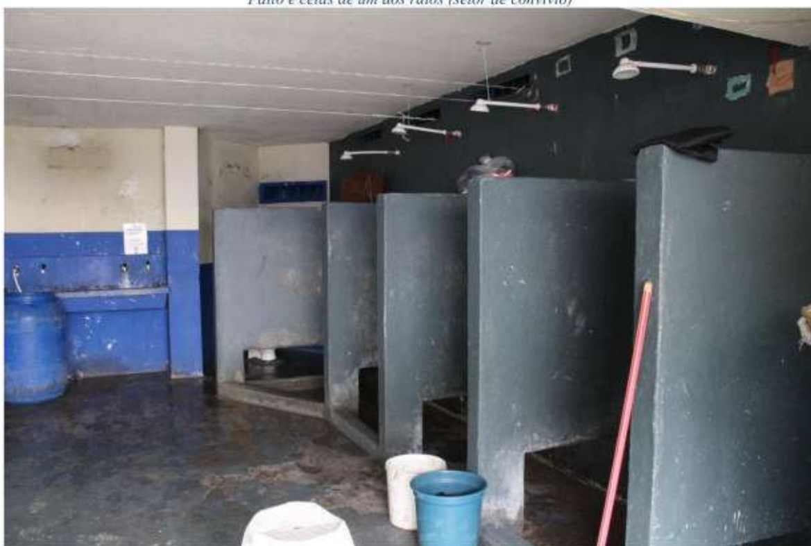
Chuveiros existentes na área comum do raio
