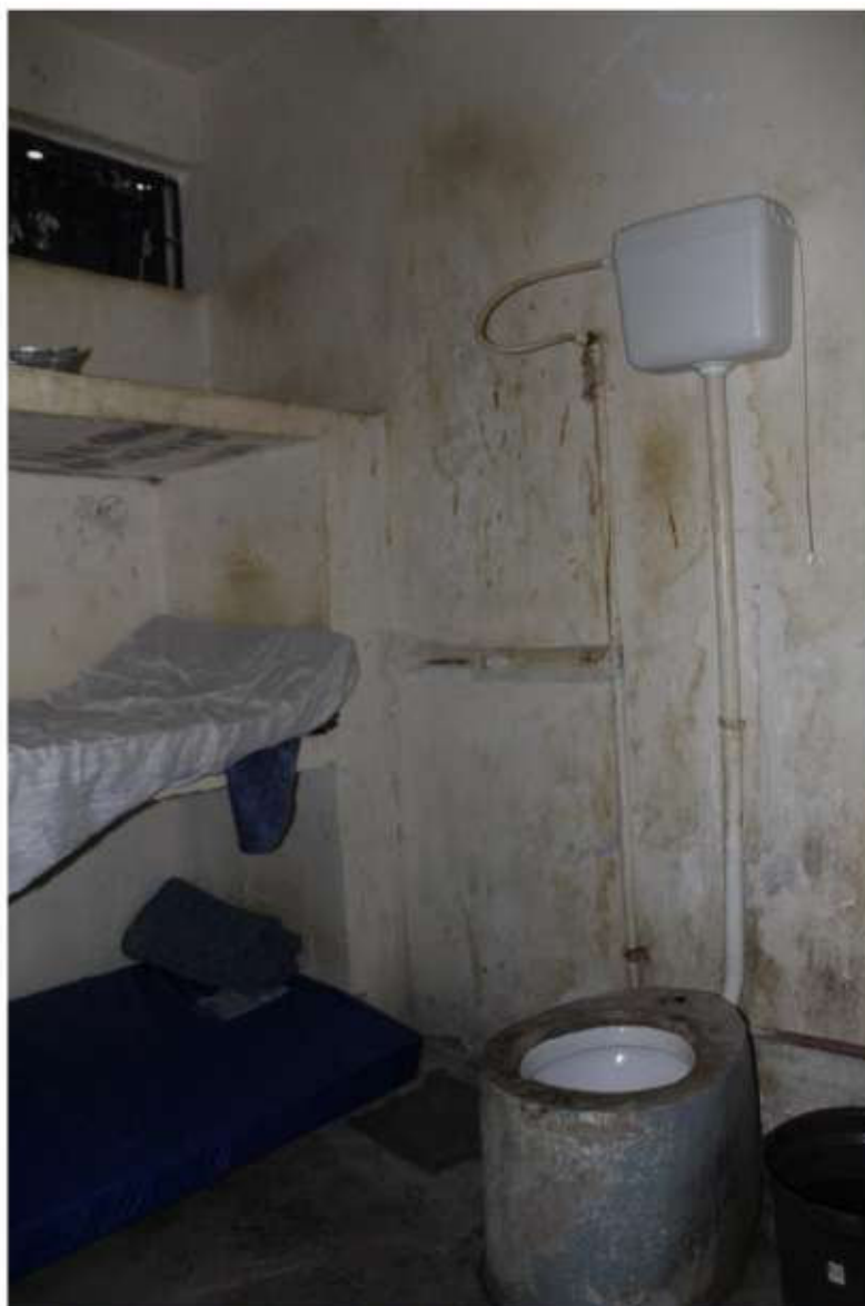
Enfermaria: cela de isolamento (foto tirada com flash diante da ausência de iluminação natural ou artificial)
