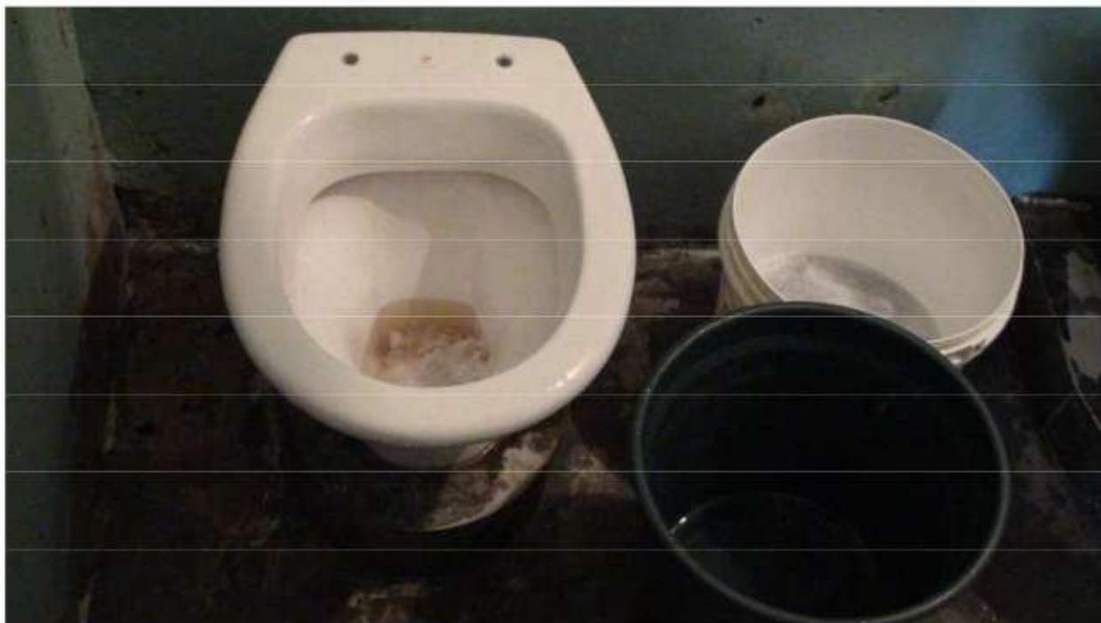
Vase sanitário de uma das celas, com descarga quebrada.
