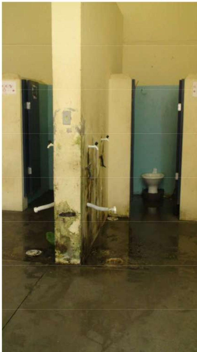
Sanitários no raio, utilizados por visitantes, com instalações hídricas em mau estado de conservação
