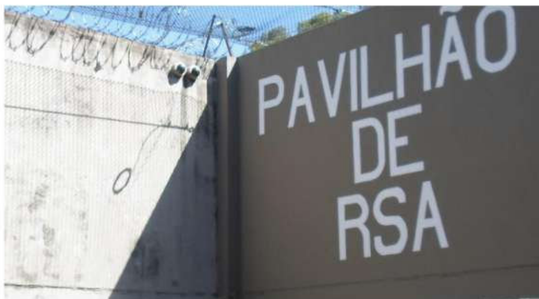
Figura 37. Câmeras instaladas no "pavilhão do semiaberto"
