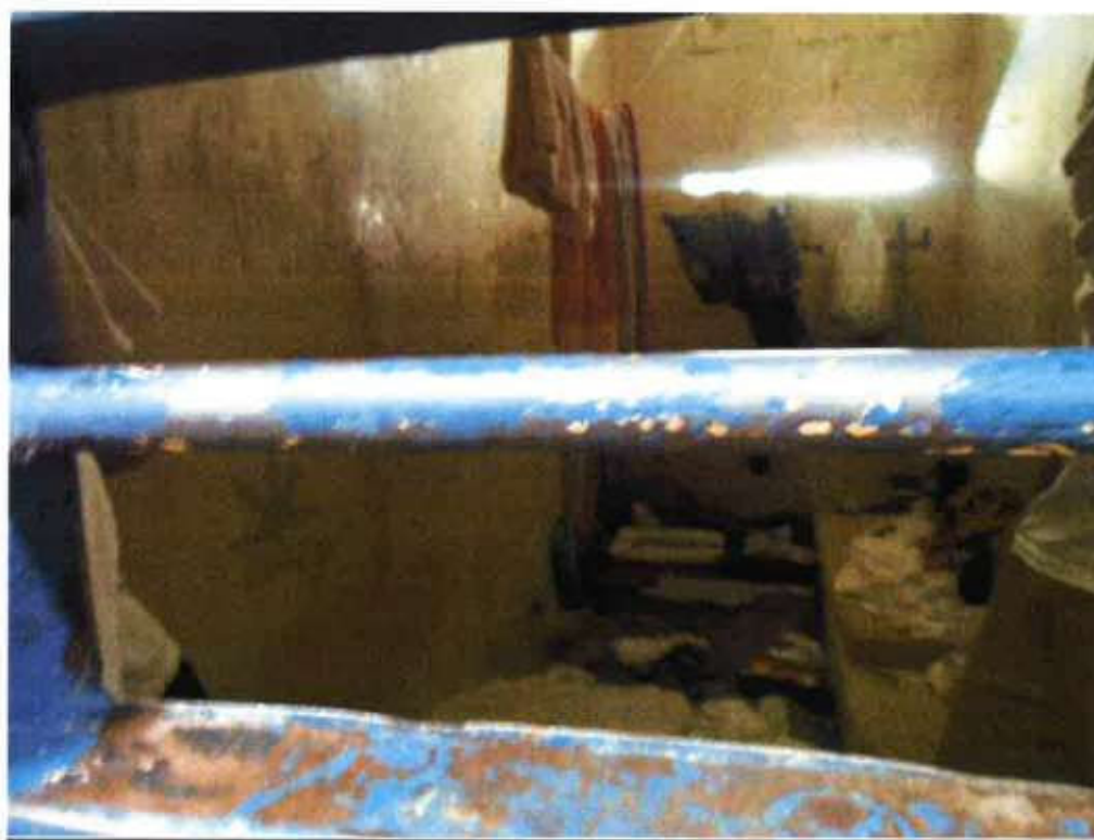
Foto 24 – cela disciplinar em mau estado de conservação.
