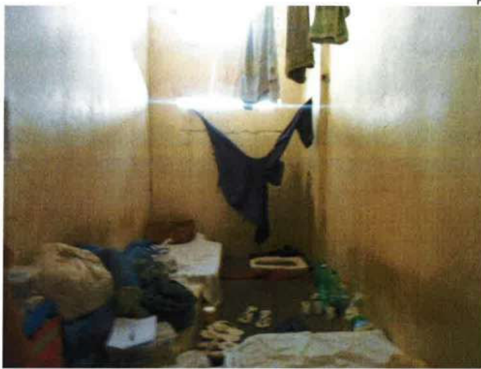
Foto 29 – Cella disciplinar em mau estado de conservação. Aparelho sanitário próximo aos alimentos, bem como das vestes dos sentenciados.
