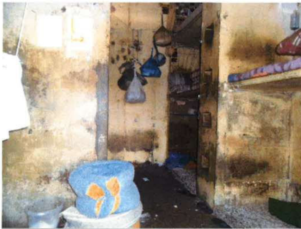
Foto 37 - Cella úmida, escura, suja e com baratas.
