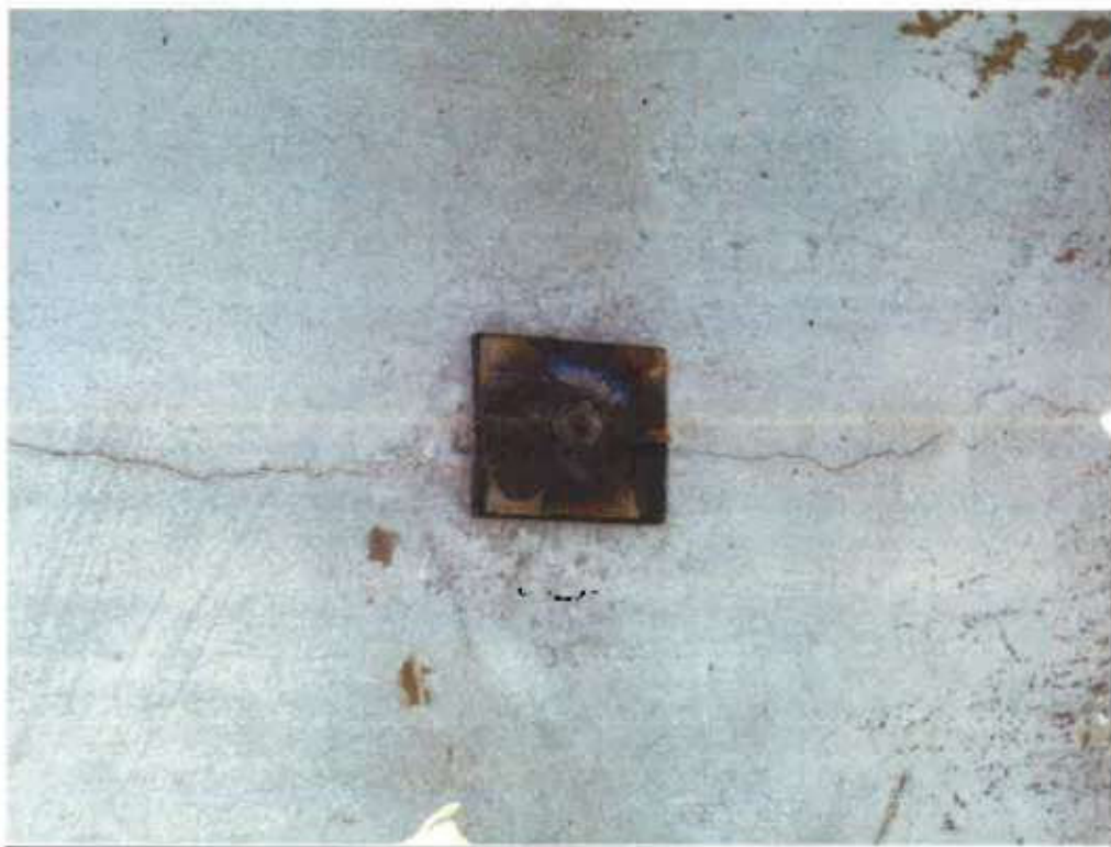
Foto 50 – Buraco na parede do pavilhão. Abuso na aplicação de sanção coletiva aos sentenciados.
