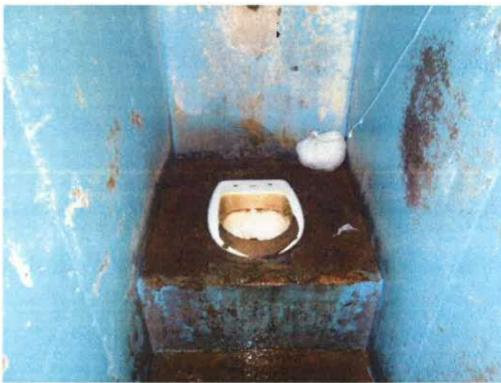
Foto 40 – Aparelho sanitário em mau estado de conservação com risco de contaminação e infecções.
