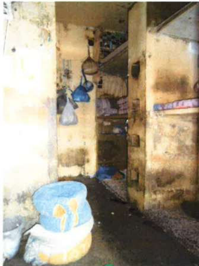
Foto 36 – Cella úmida, escura, suja e com baratas.
