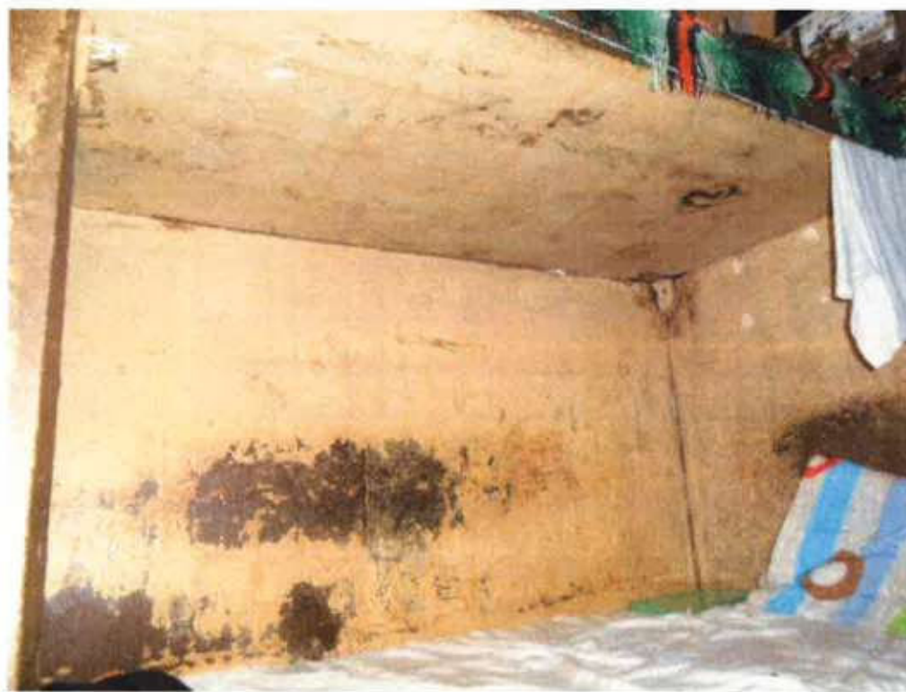
Foto 38 - Cella úmida, escura, suja e com baratas.
