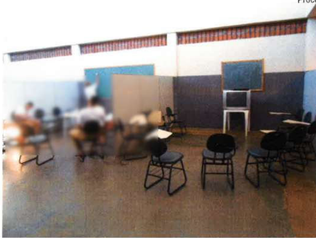
Foto 19 – Sala de aula aberta com quadro negro, mas sem estrutura para impedir os raios solares ou a água da chuva.
