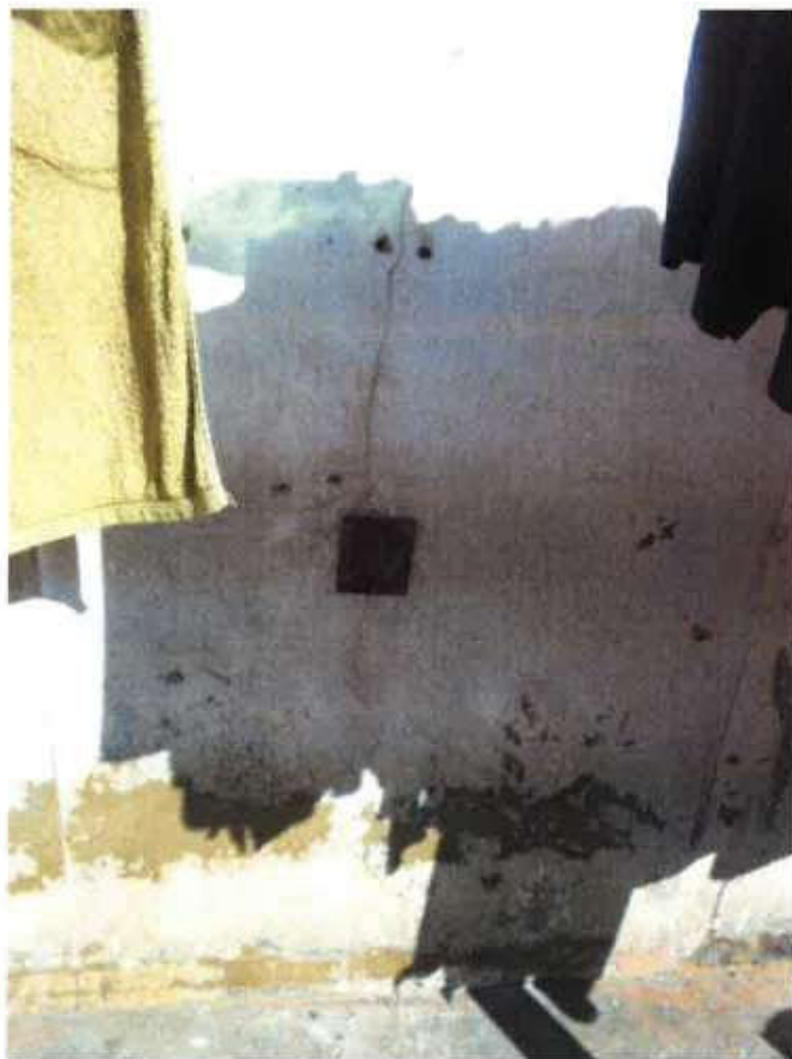
Foto 51 – Buraco na parede do pavilhão.
