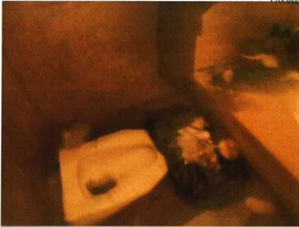
Foto 27 – Cella disciplinar em mau estado de conservação. Aparelho sanitário próximo aos alimentos, bem como das vestes dos sentenciados.
