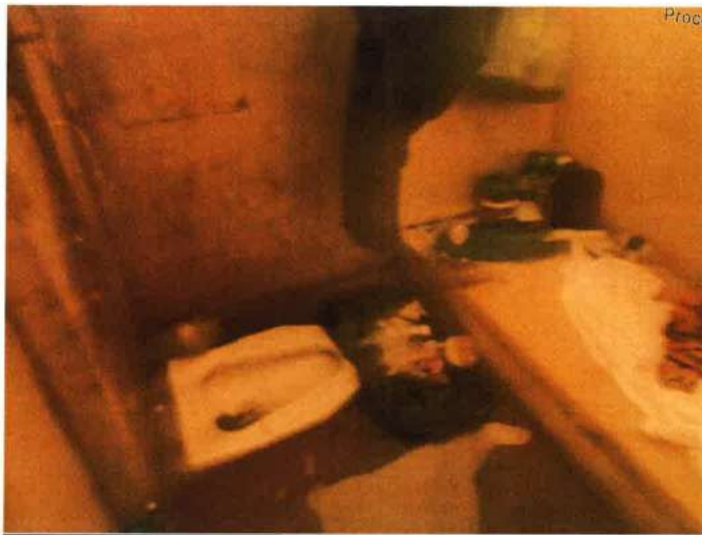
Foto 25 – Cella disciplinar em mau estado de conservação. Aparelho sanitário próximo aos alimentos, bem como das vestes dos sentenciados.
