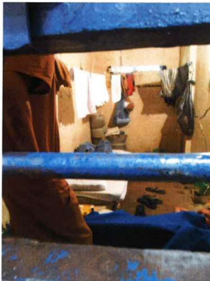
Foto 23 – Cella disciplinar em mau estado de conservação.
