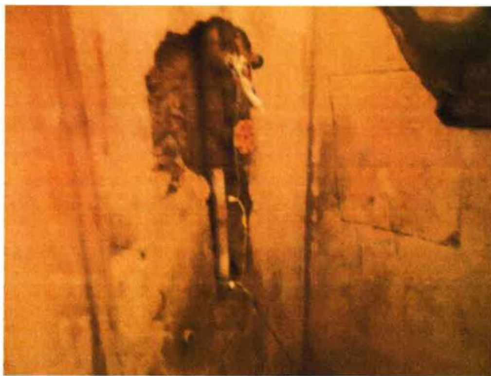
Foto 26 – Cella disciplinar com problemas de encanamento. Não havia chuveiro para banho.
