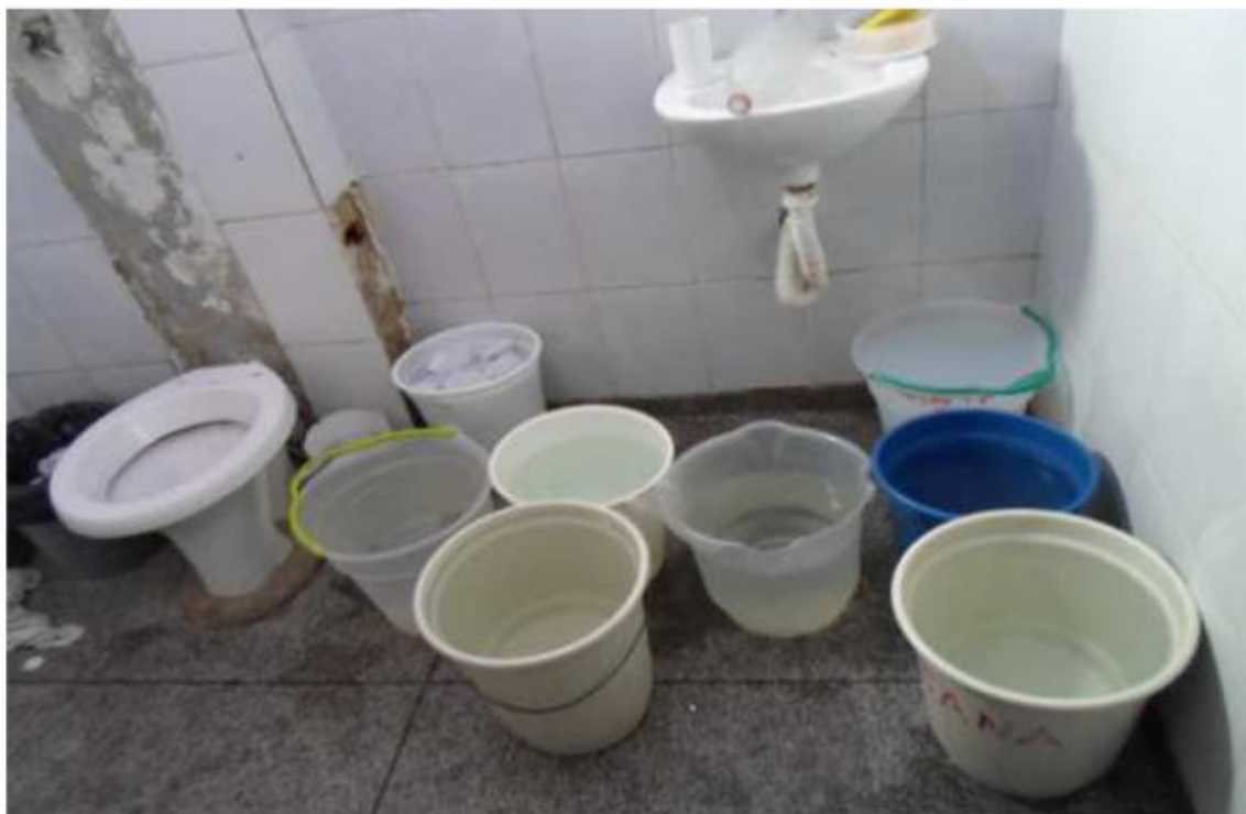
Foto 21. Banheiro com diversos baldes.
