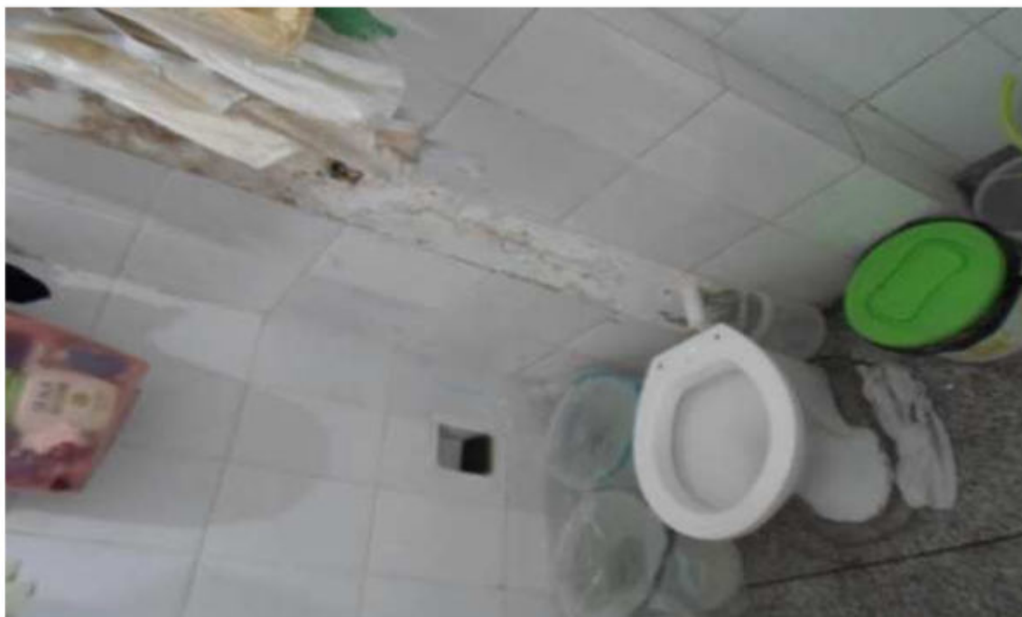
Foto 19. Banheiro de uma das celas. Baldes para conter vazamentos.
