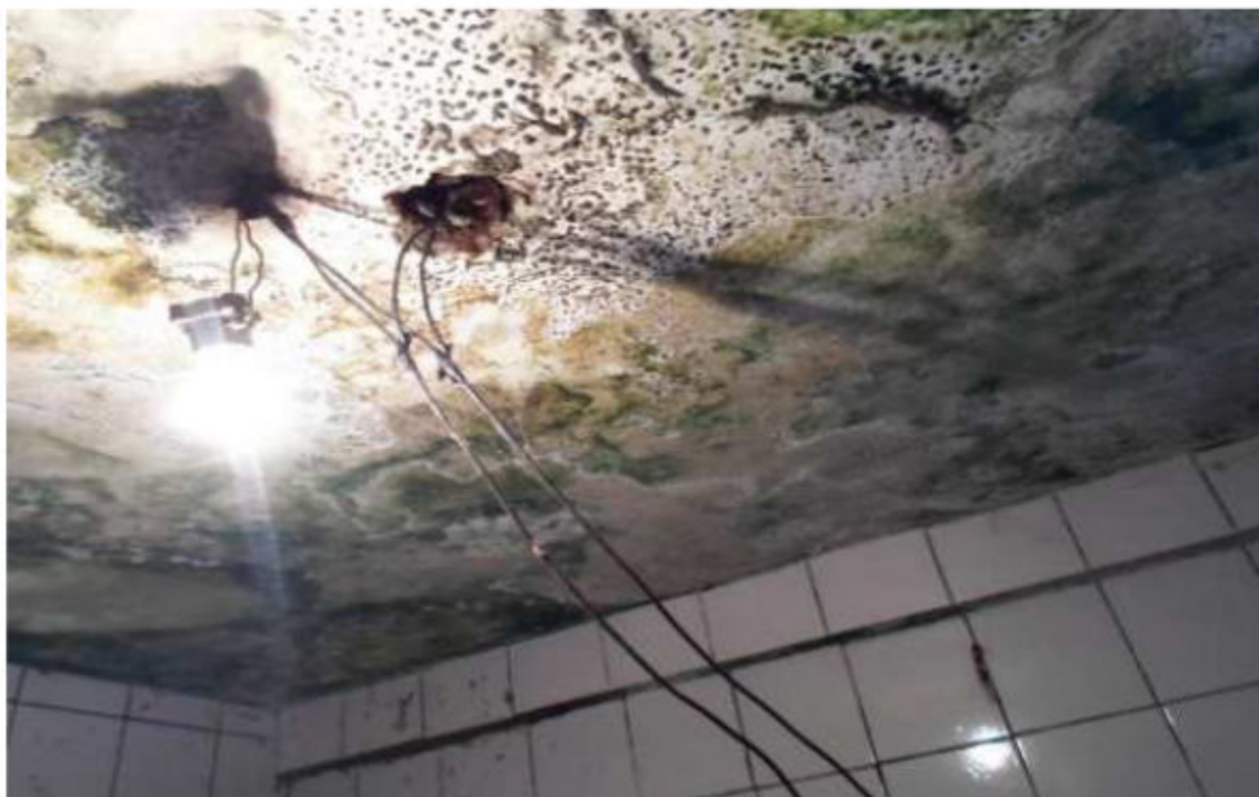
Foto 24. Infiltrações e fiação elétrica.
