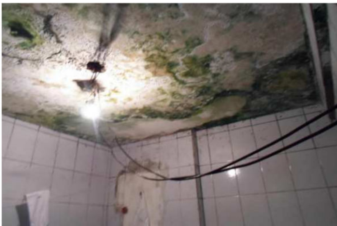
Foto 23. Infiltrações e fiação elétrica.
