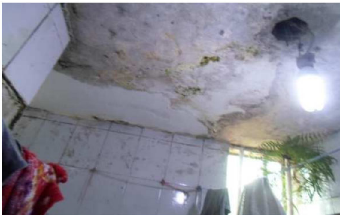
Foto 22. Teto do banheiro.
