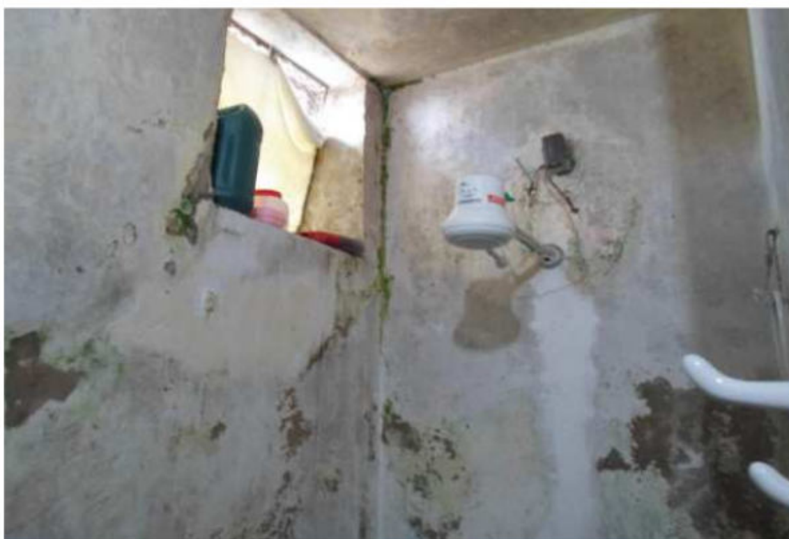
Foto 20. Chuveiro com infiltrações.
