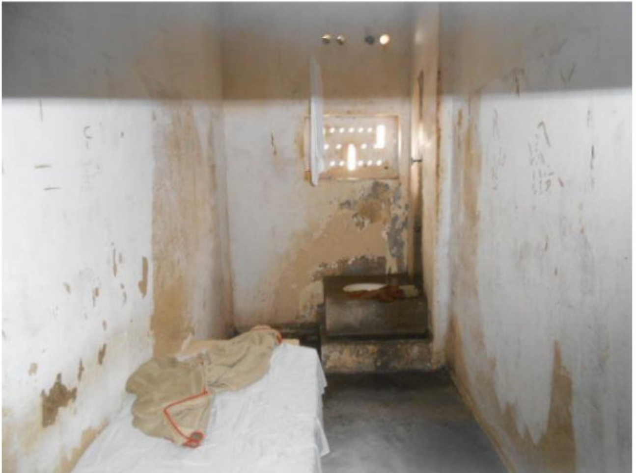
15. Condições precárias de cela do “castigo”.
