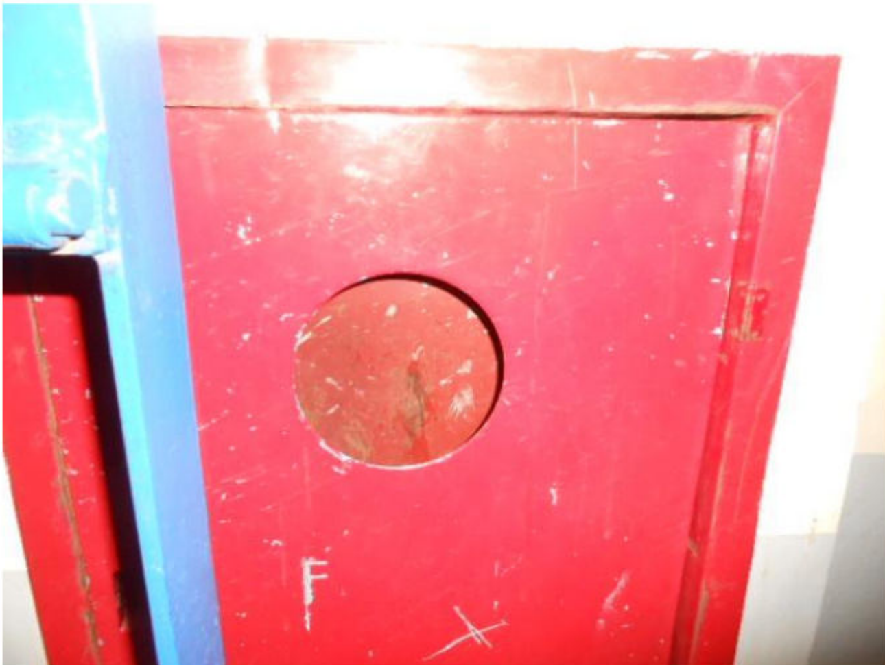
21. Ausência de extintor de incêndio na ala de “saúde”
