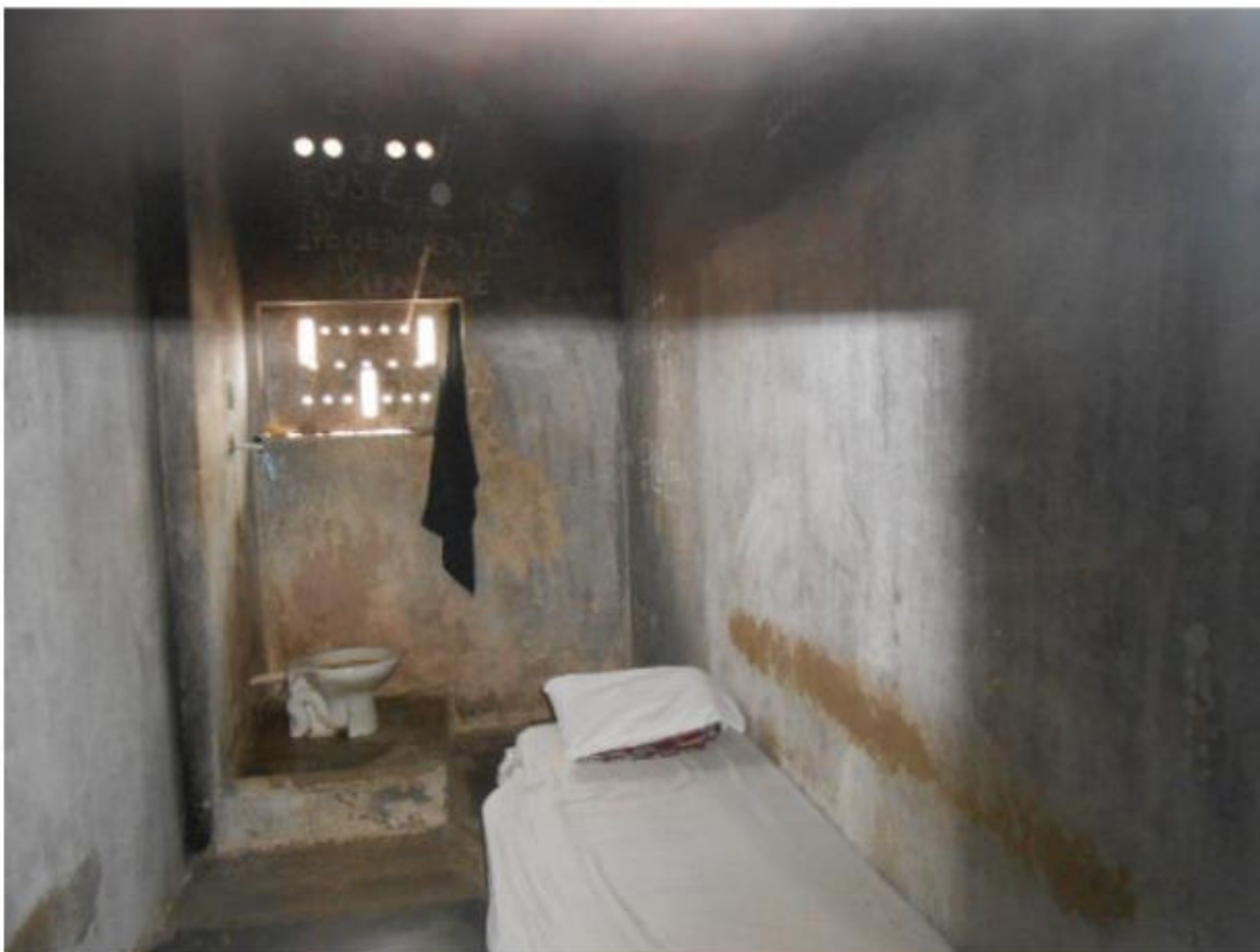
16. Condições precárias de cela do "castigo".
