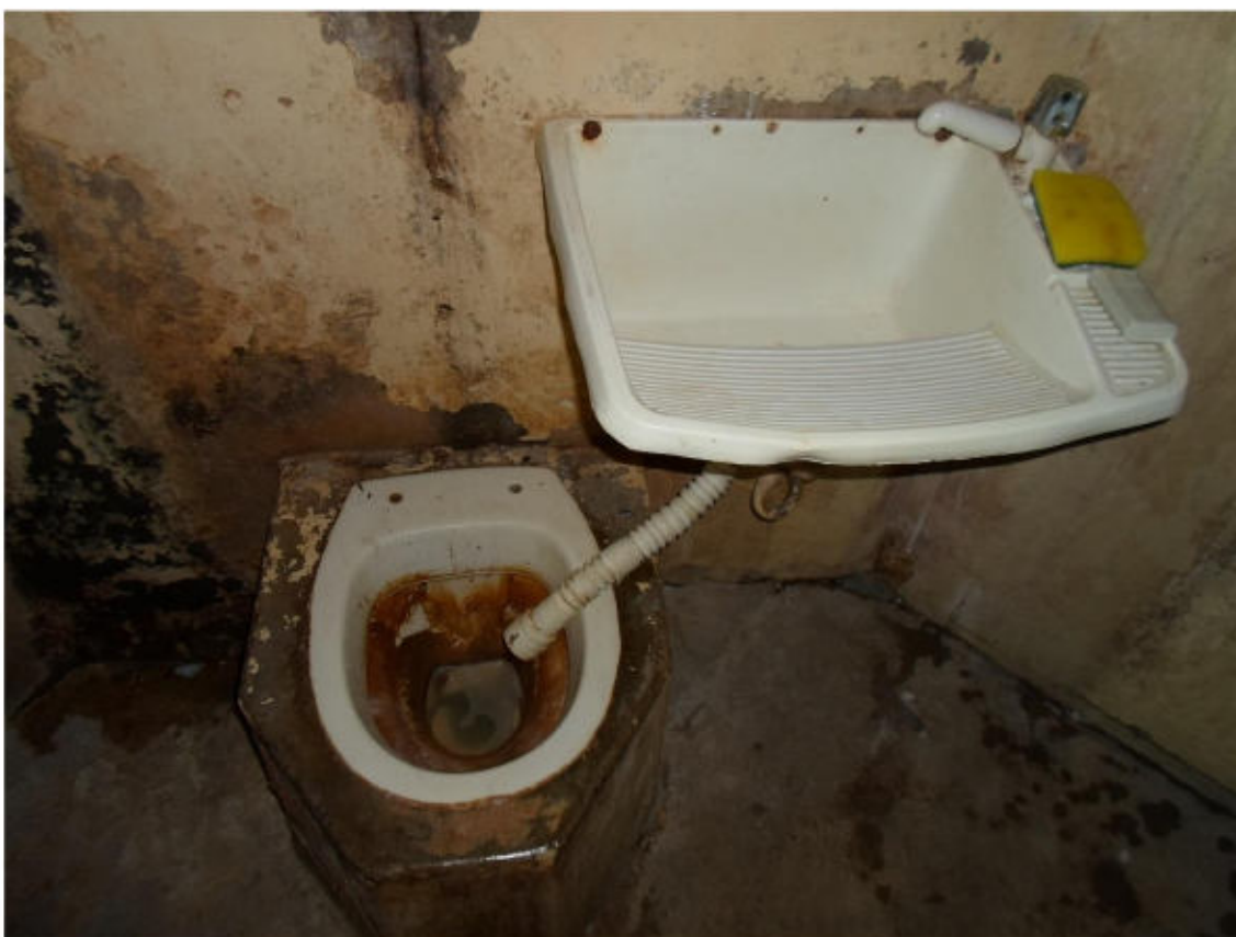
(condições do sanitário do castigo)
