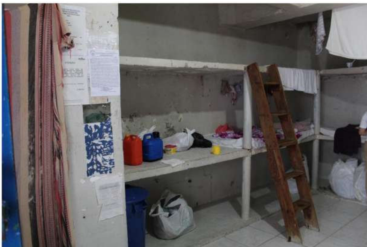
Precariedade da escada que dá acesso às camas superiores
