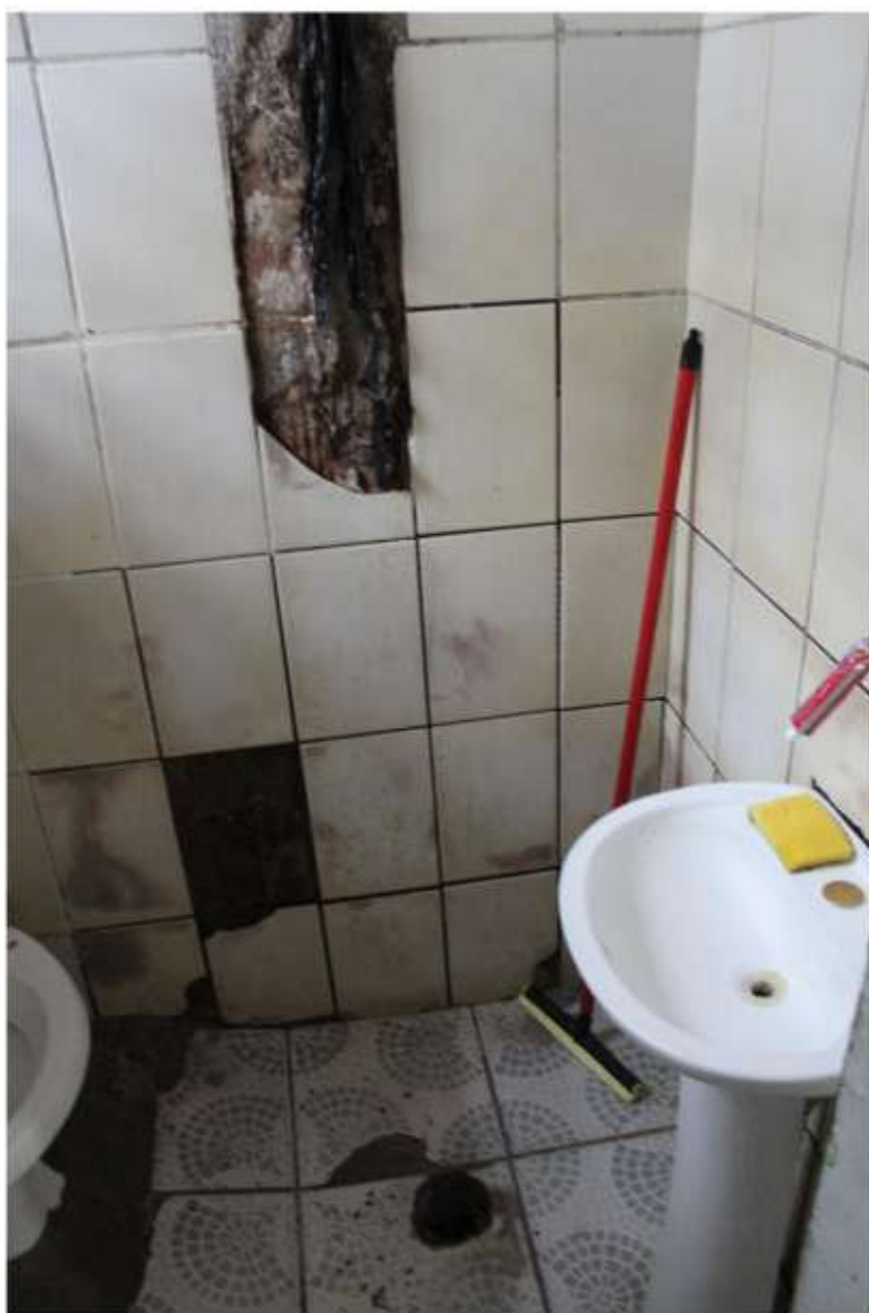
Precariedade das instalações e infiltração
