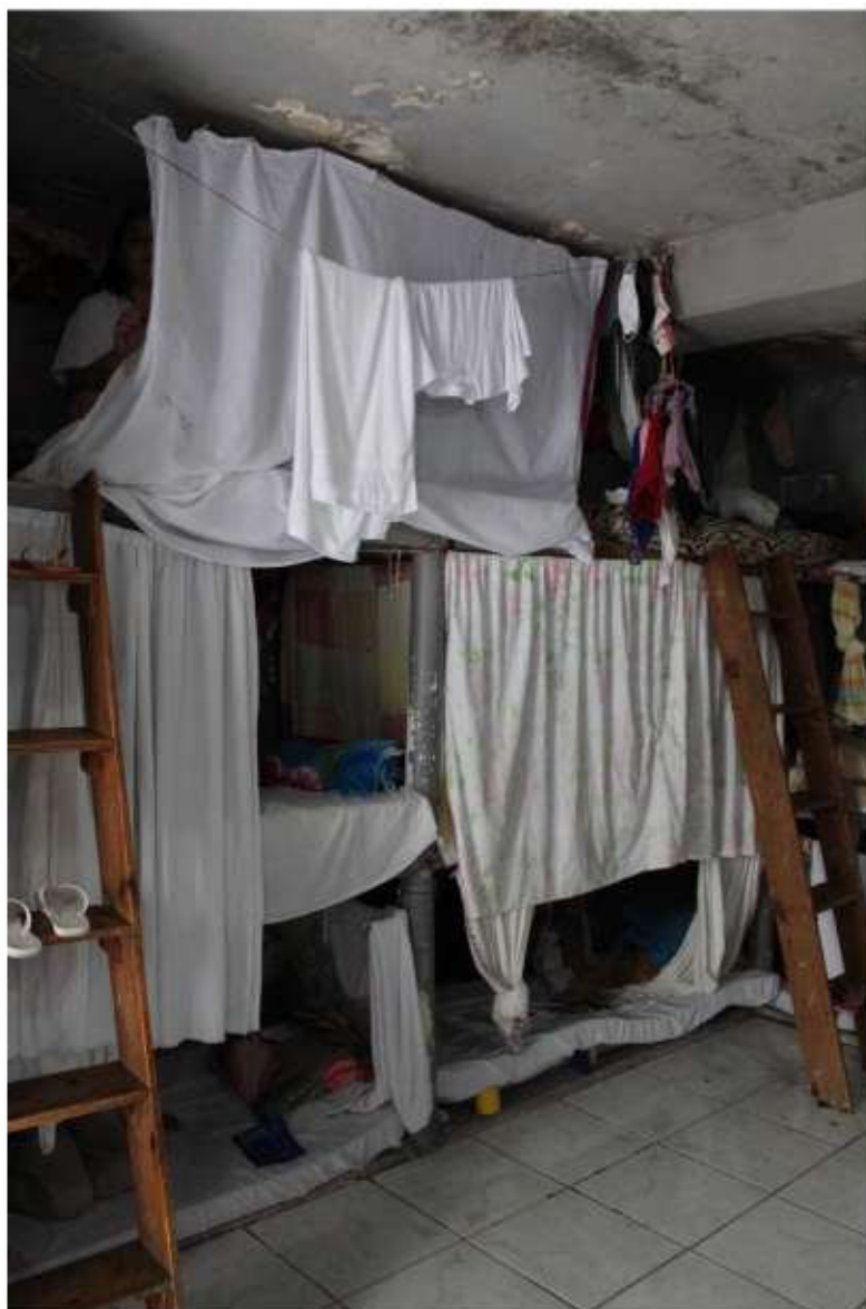
Aspecto desgastado das escadas de acesso às camas superiores
