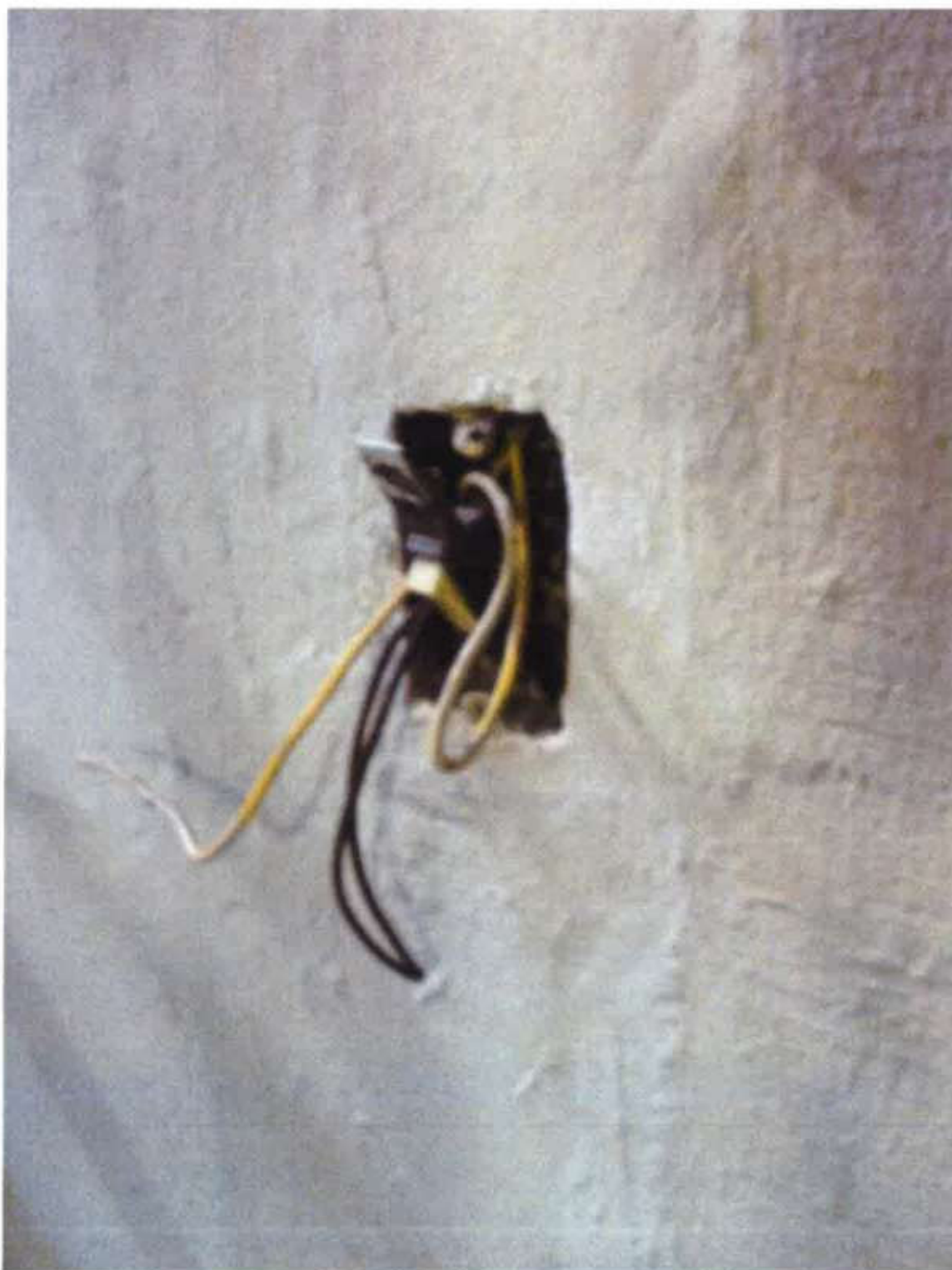
Foto 38 – fiação elétrica exposta e desemcapada
