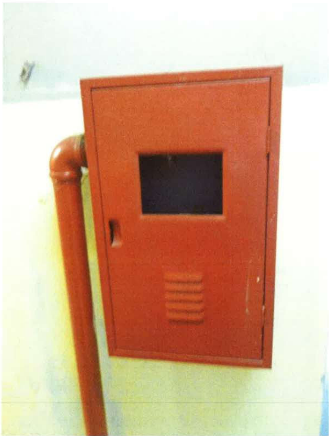
Foto 37 – ausência de equipamento contra incêndio
