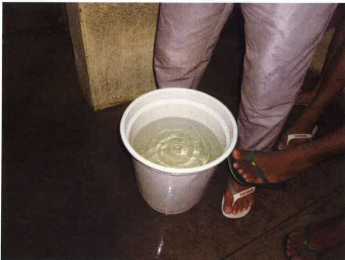
Foto 24 – cela com vazamento de agua, completamente alagada
