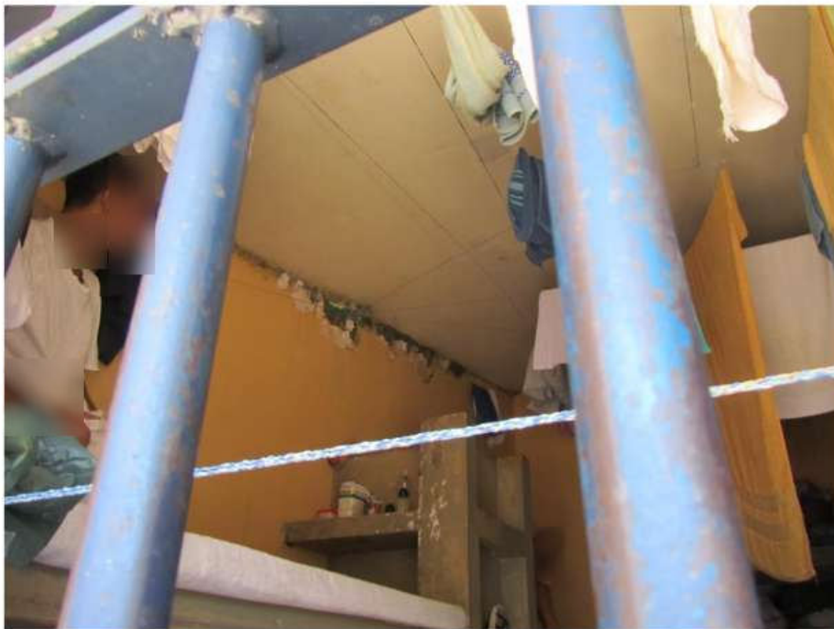
Imagem 16: danos estruturais. Sabão no teto para contenção de vazamentos.
