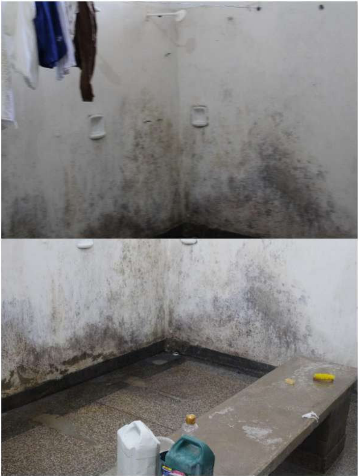
Banheiro com mofo
