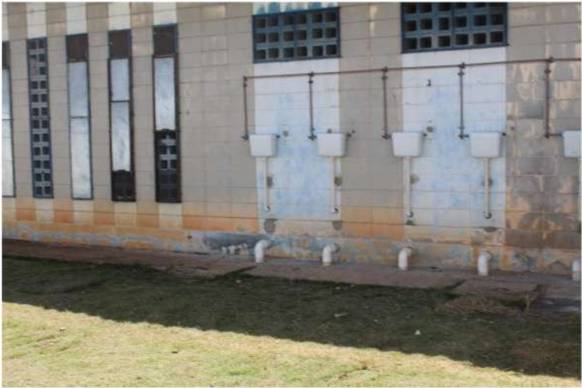
Privadas com as caixas de água localizada no exterior do convívio
