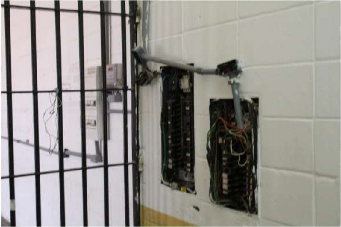
Instalações elétricas precárias
