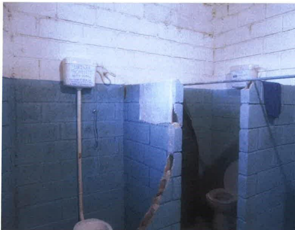
(Registro fotográfico do banheiro quebrado)
