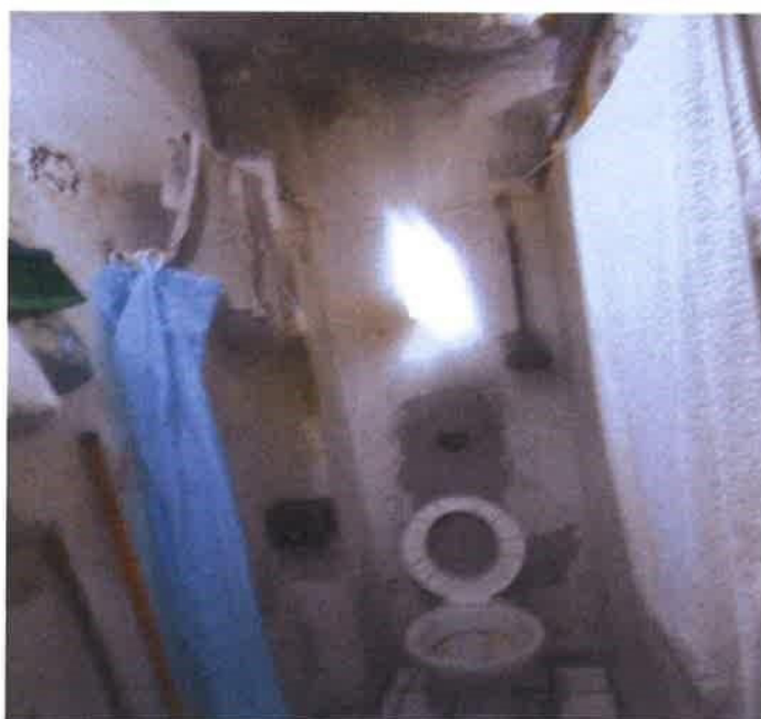
(Registro fotográfico da condição do banheiro, com inúmeras infiltrações)
