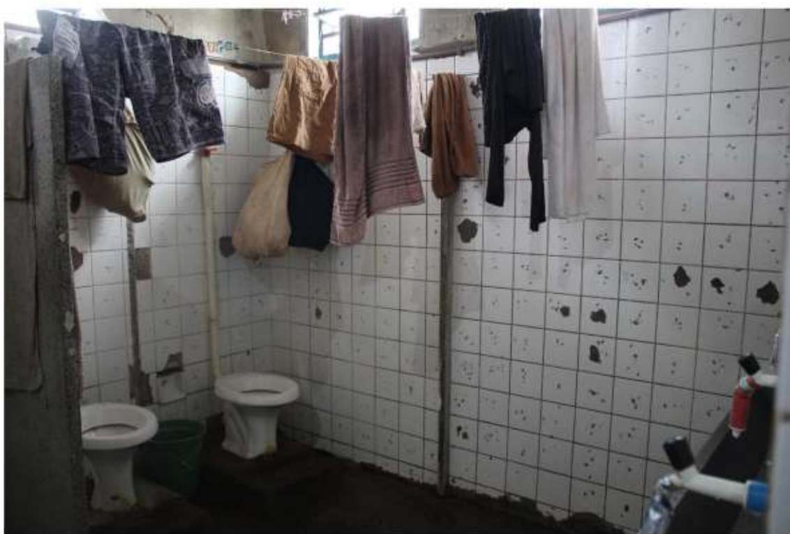
(sanitários com vazamentos)
