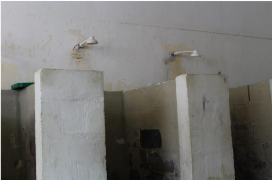
(Imagem dos chuveiros com água quente instalados no pátio).
