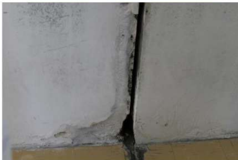
(rachaduras separam o chão e a parede do prédio)
