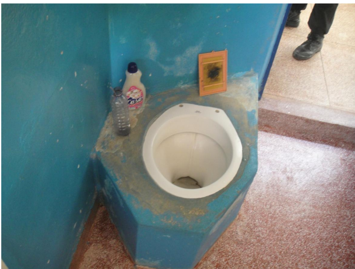
Vaso sanitário em cela do pavilhão 1.
