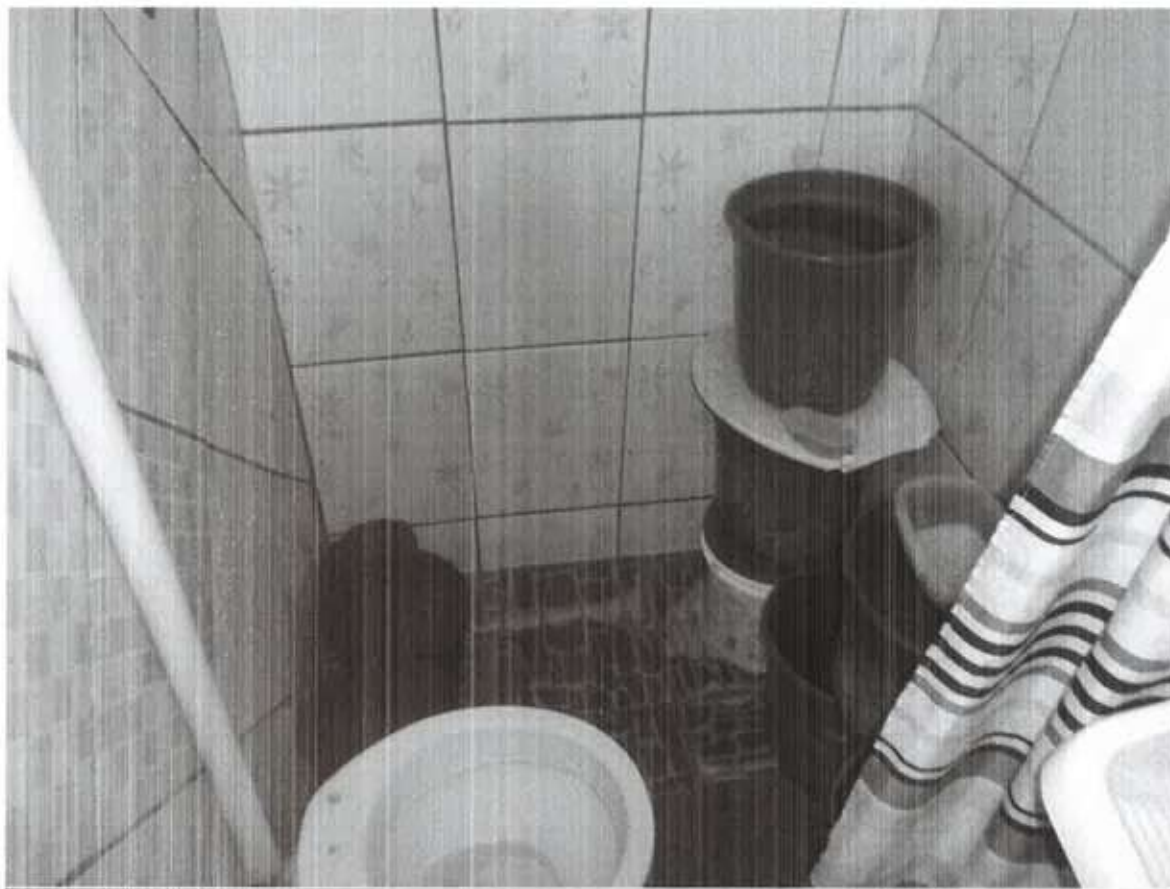
Figura 46 - Detalhe do banheiro da cela do regime semiaberto (água armazenada em baldes)
