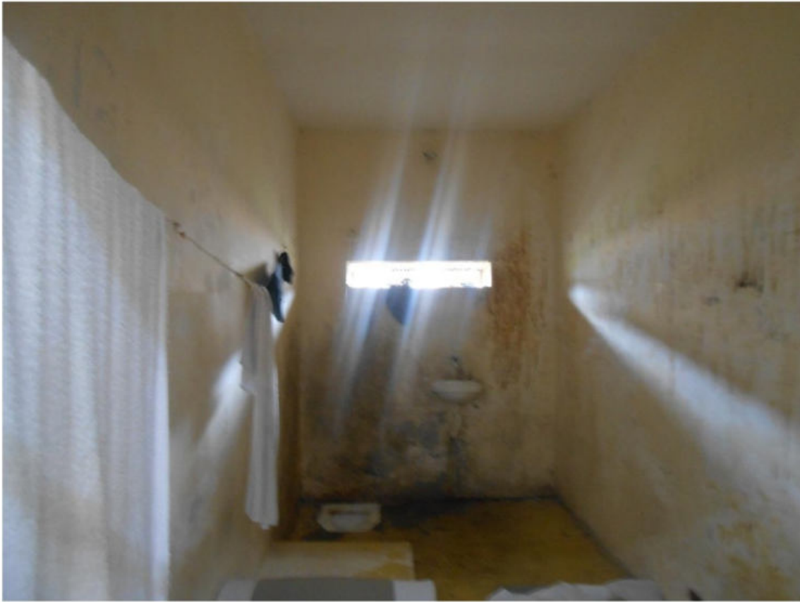
(Cela do castigo – sem vaso sanitário, sem janela, úmida e sem ventilação)
