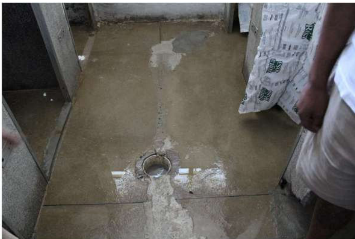
(Área alagada do banheiro coletivo da Ala de Progressão)
