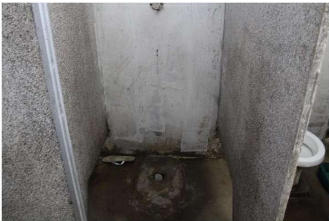
(Ausência de vaso sanitário no banheiro coletivo do Ala de Progressão)
