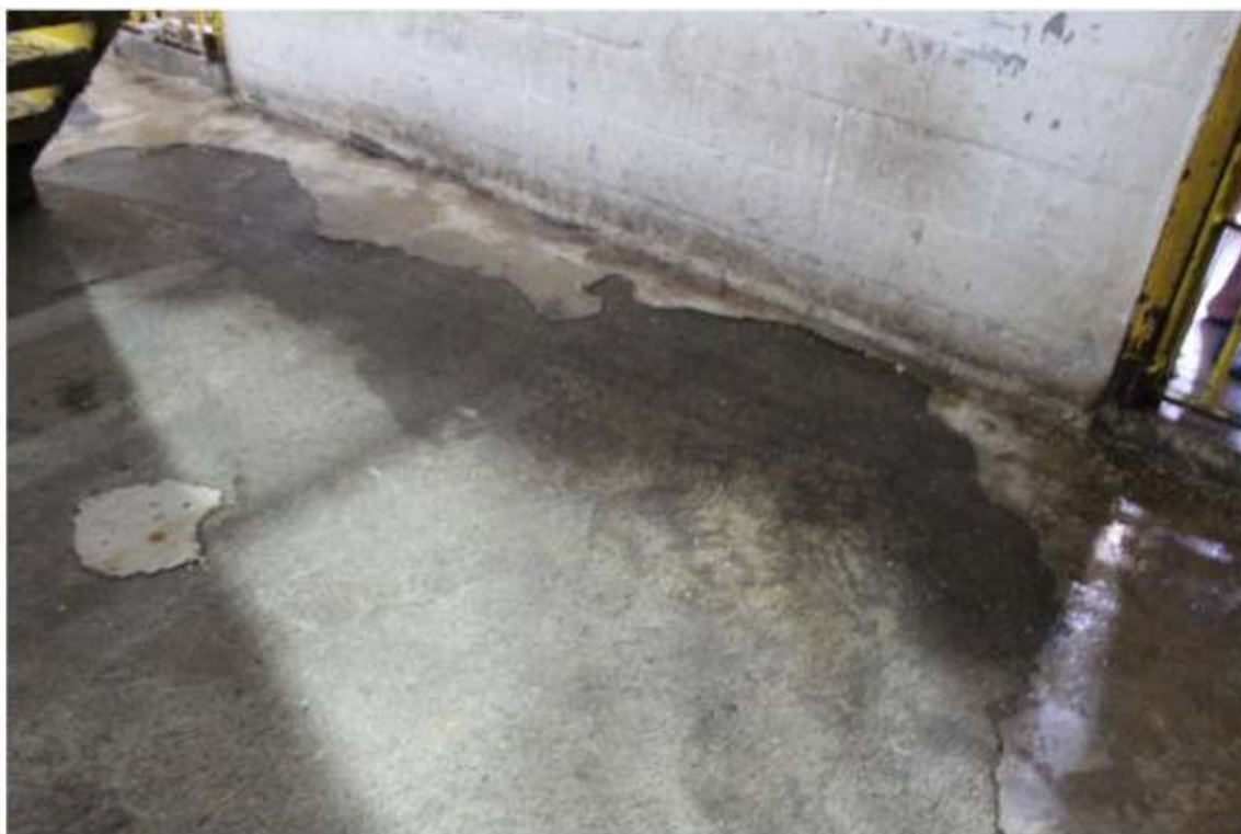
(Chão do corredor do pavilhão alagado)
