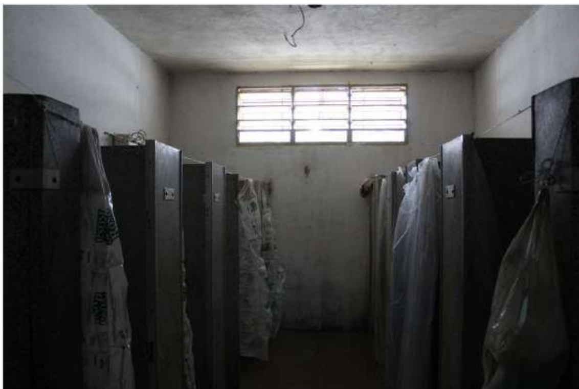
(Área do banheiro coletivo da Ala de Progressão com iluminação precária)
