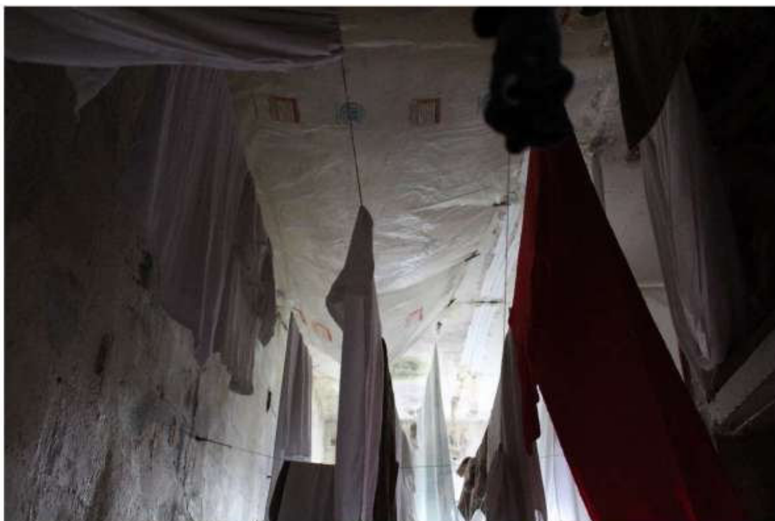
(Infiltração nas paredes e lona de plástico no teto da cela 25)
