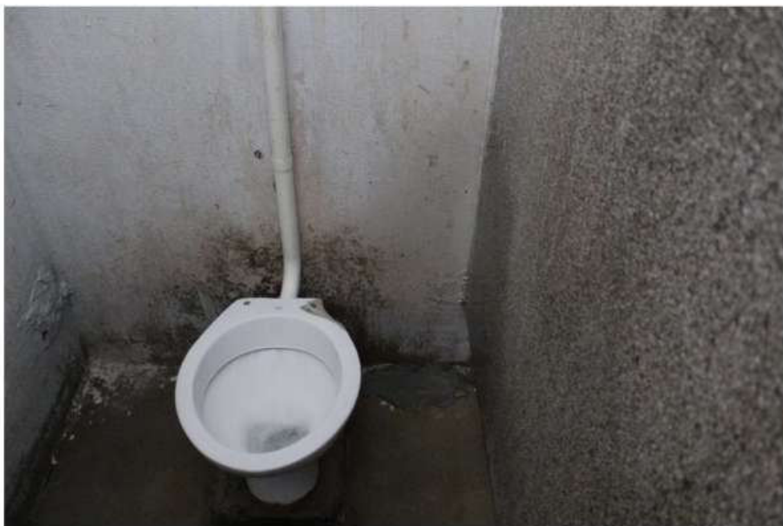
(Vaso sanitário danificado no banheiro coletivo da Ala de Progressão)
