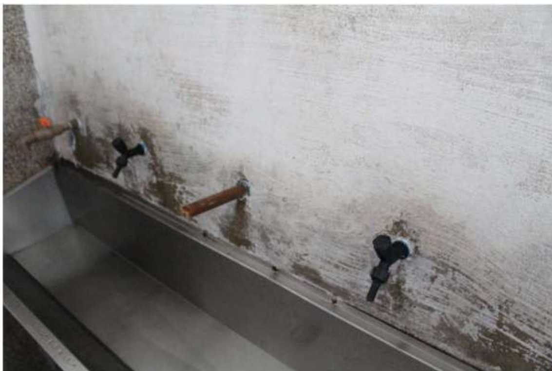
(Pia do banheiro coletivo da Ala de Progressão)
