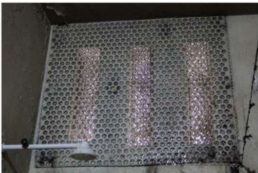
Ventilação e iluminação inadequadas no setor disciplinar
