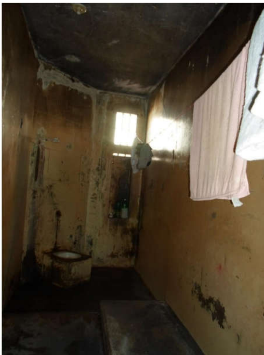
Foto 8 – cela do setor de disciplina – iluminação e ventilação inadequados – péssimas condições de higiene – sem colchão
