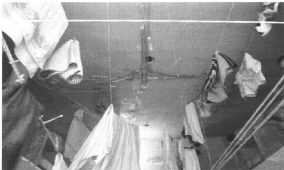
Calhas improvisadas pelos próprios presos para conter as infiltrações de água.
