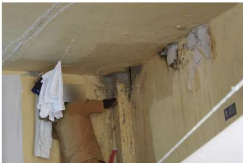
Cela com sérios problema de infiltração
