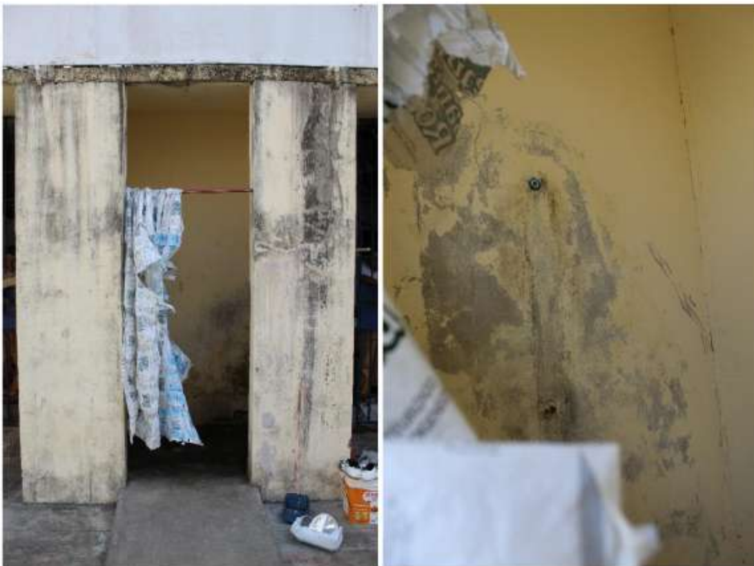
Detalhe do local externo que seria utilizado para banho, porém sem chuveiro.
