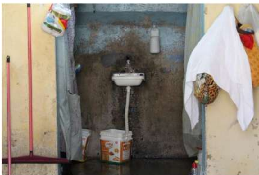
Cela com vazamento na pia
