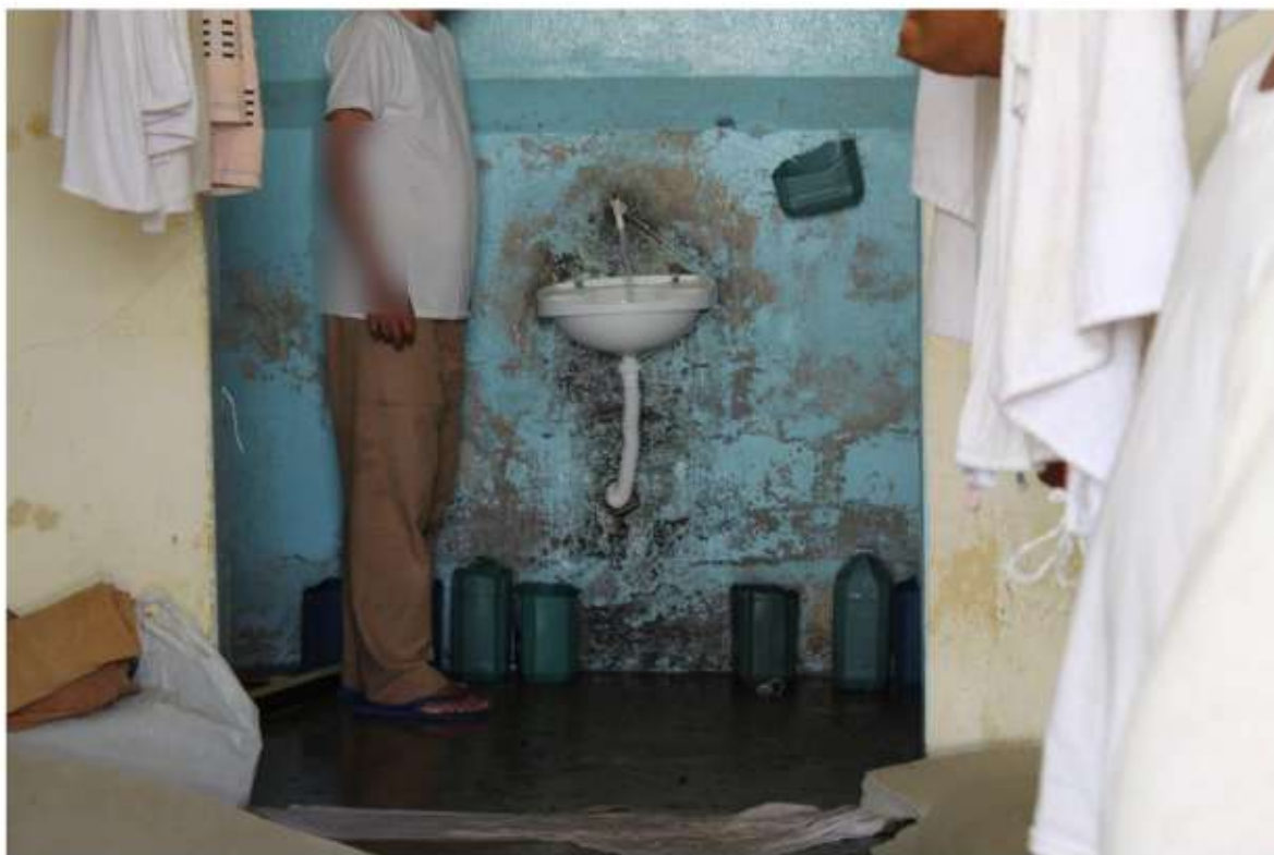
Foto do interior de uma das celas do raio 1B com problemas de vazamento na pia
