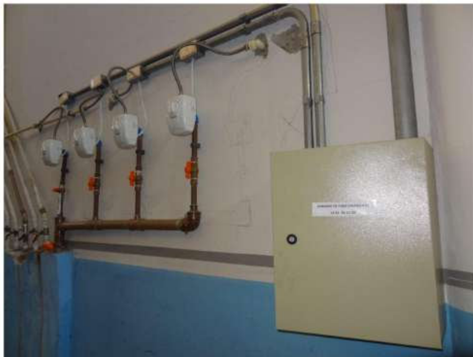
Mecanismos para o acionamento do sistema de aquecimento da água, no lado externo dos raios
