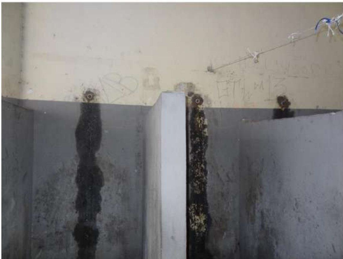
Saídas de água dos espaços comuns de banho, com sistema externo de aquecimento de água, que permanece desligado
