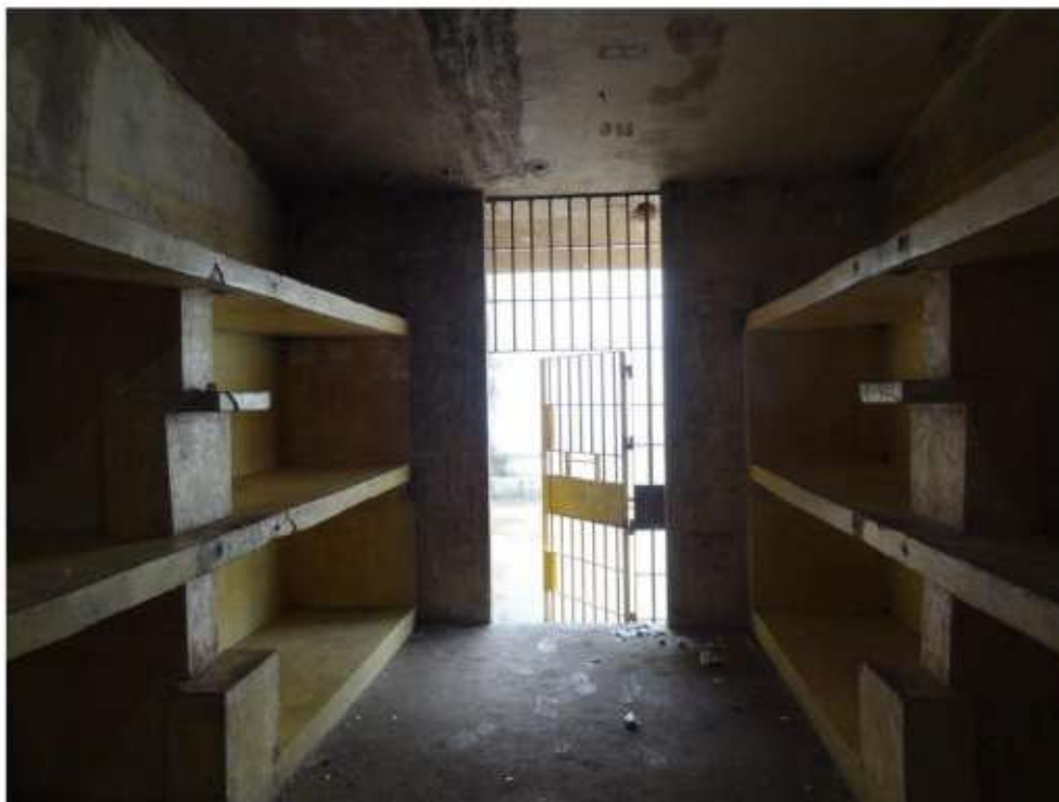
Ausência de espaços para ventilação ou iluminação natural
