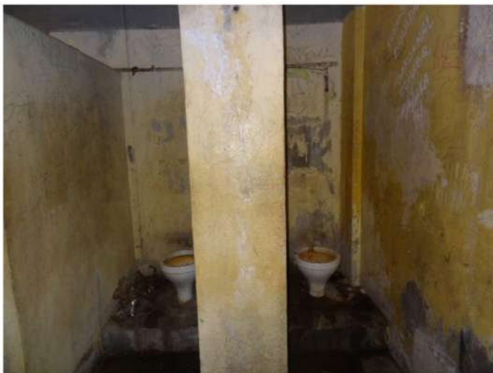
Vasos sanitários destinados a visitantes
