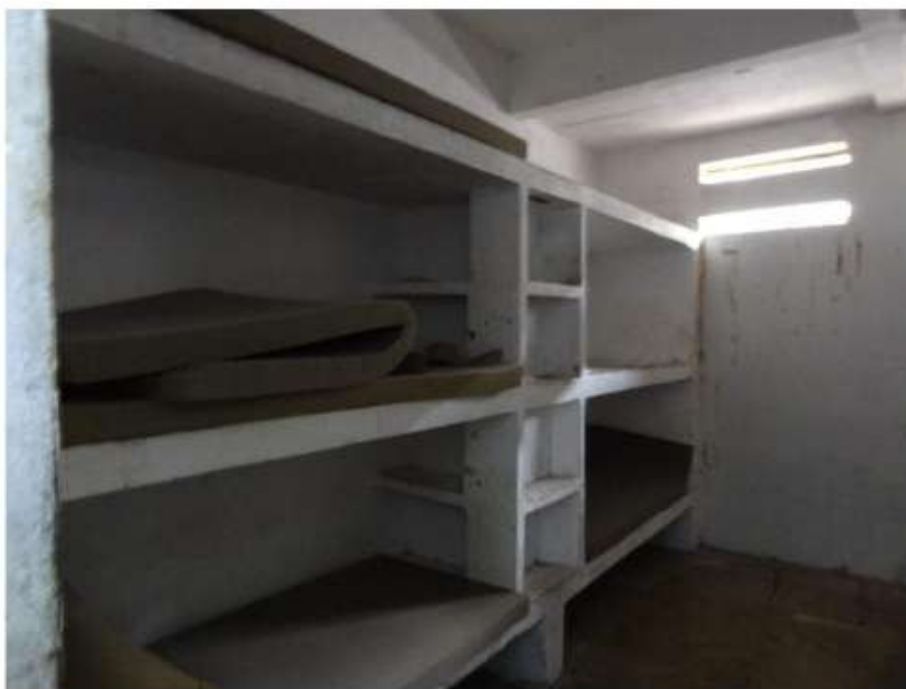
Interior de uma das celas de inclusão
