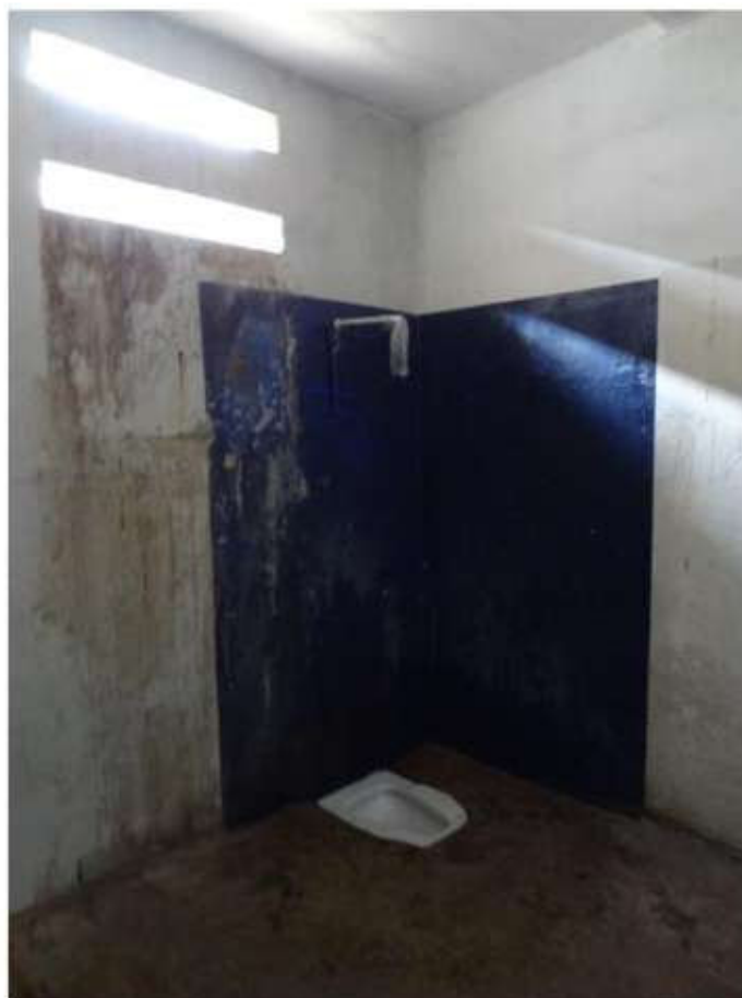
Instalações hidráulicas de uma cela da inclusão
