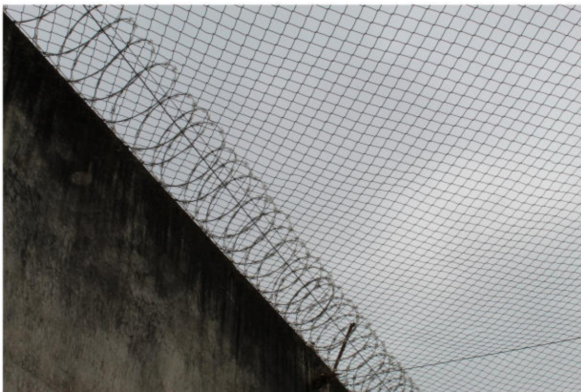
Imagem 26: grade de proteção com ninhos de pombo
