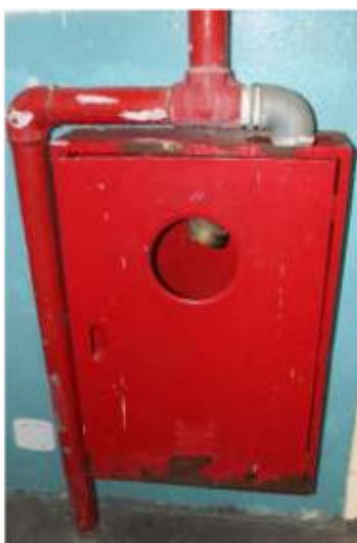
(fotografia tirada na inspeção dos materiais de segurança – faltantes)
