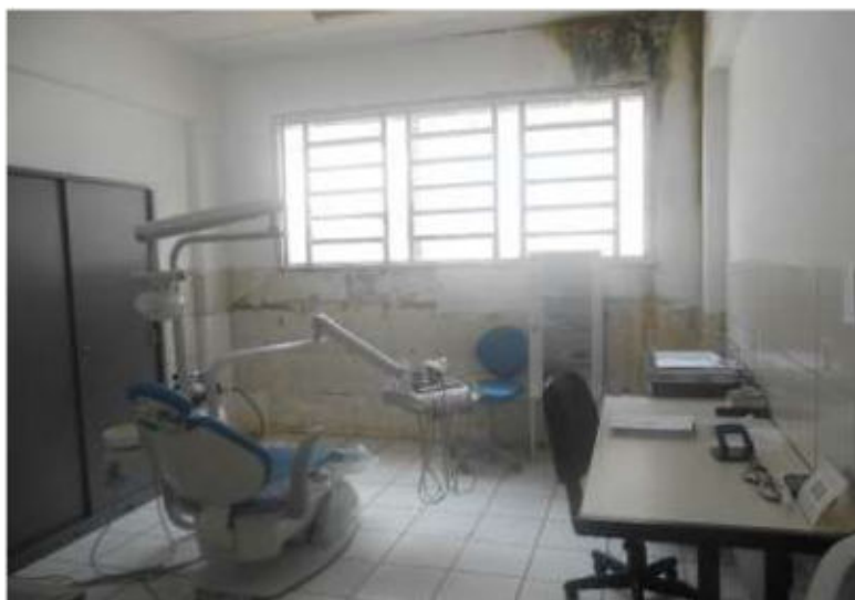
(sala do atendimento odontológico com sinais evidentes de mofo nos teto e parede)
