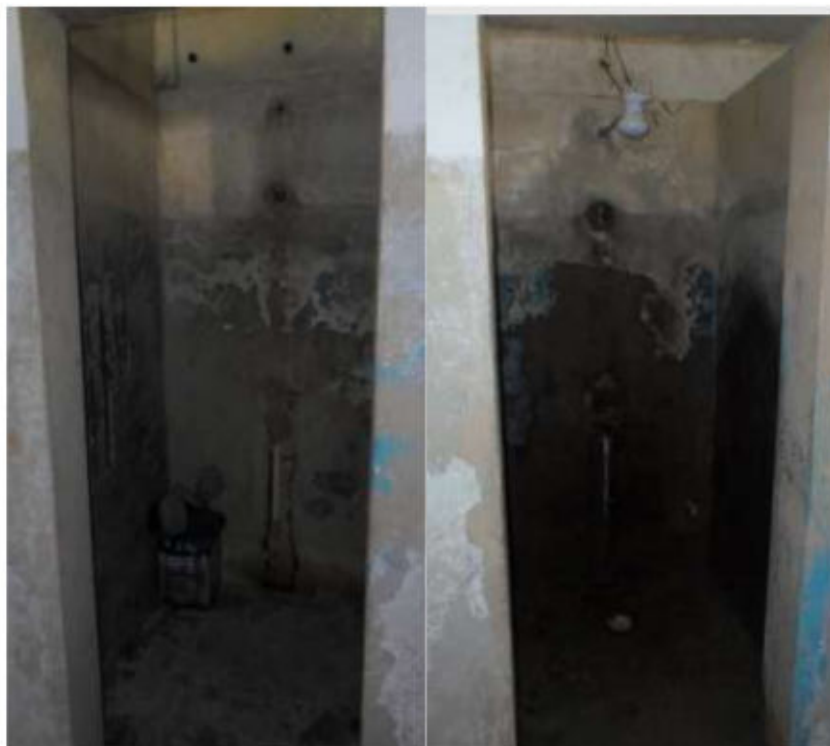
(condições dos chuveiros nos raios)
