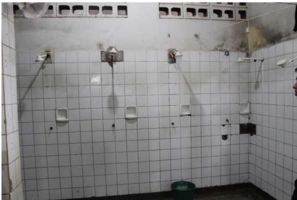
Destaque para o chuveiro quebrado à direita
