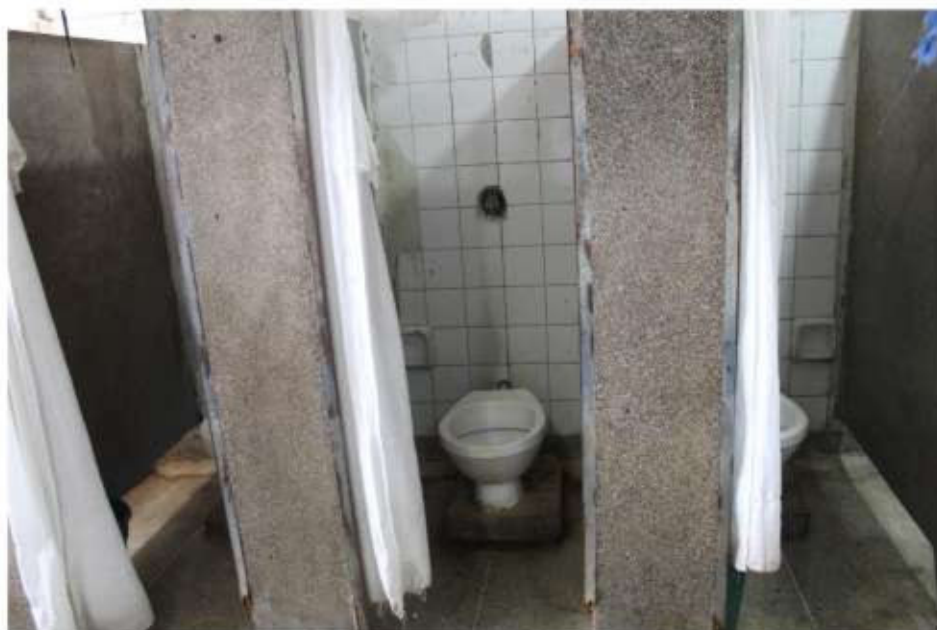
Destaque para a falta de acessibilidade do banheiro utilizado pelos presos com deficiência
