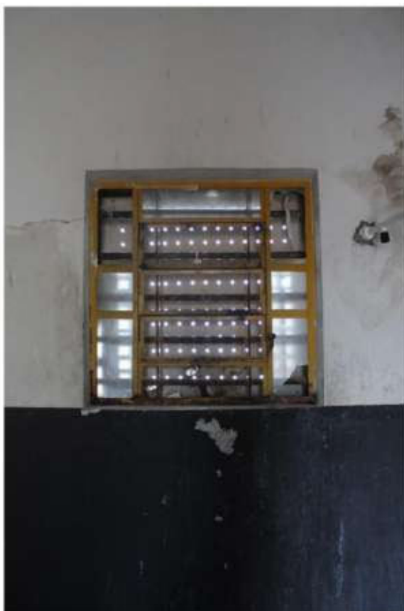
Destaque para a pequena entrada de ar no fundo da cela que prejudica a ventilação cruzada
